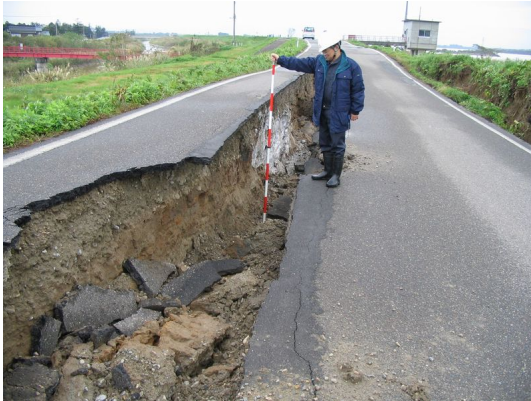
写真-1 信濃川右岸 6.5km 与坂町東与坂 (堤防天端に生じた段差。最大 80cm 程度。)
