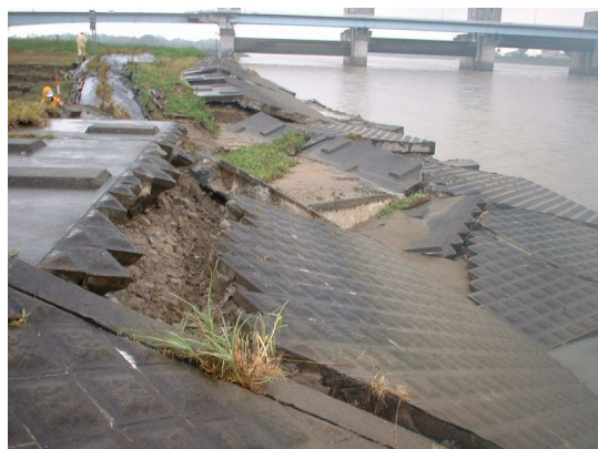
写真-6 信濃川左岸 30.1km (低水護岸が約 30m に渡って陥没。陥没深さは最大で 1 m 程度。)
