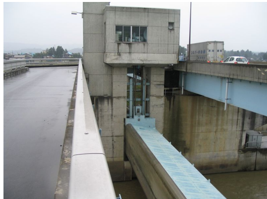
写真-4 信濃川 30.0km 妙見堰 (損傷した門柱の全景。残留変位は目視では認められない。)
