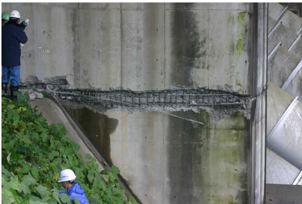
写真-5 国道 117 号線山辺橋（小千谷市山本：壁式橋脚かぶりコンクリートの剥落、軸方向鉄筋のはらみ出し）
