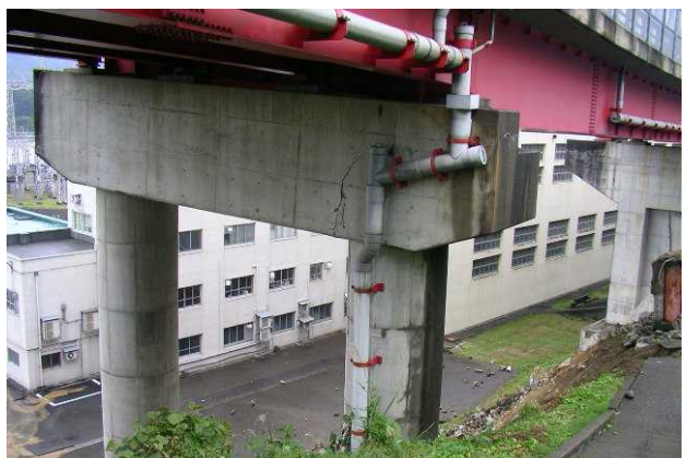
写真-6 山辺橋（ラーメン梁部のひびわれ）
