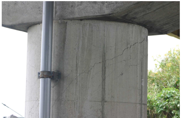
写真-4 新組跨線橋 P4 橋脚（かぶりコンクリートの斜めひびわれ）
