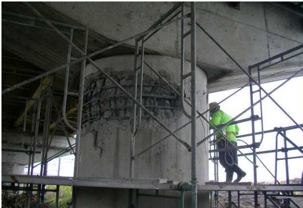
写真-3 国道 8 号線新組跨線橋 P5 橋脚（長岡市新組町：かぶりコンクリートの剥落、軸方向鉄筋段落し最上部での損傷）
