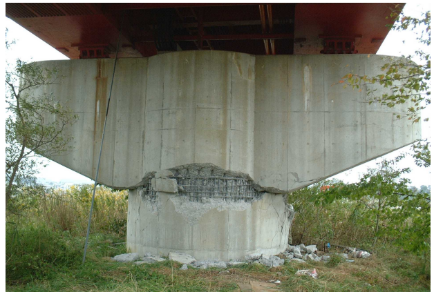
写真-2 小千谷大橋 P1 橋脚（柱と横梁基部でのかぶりコンクリートの剥落、軸方向鉄筋のはらみ出し）
