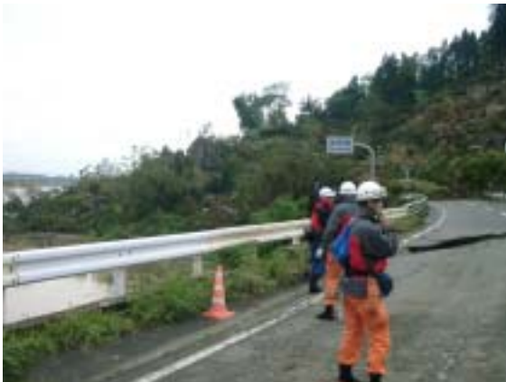
写真 - 3 崩落個所近景 (道路・河川部の状況)
