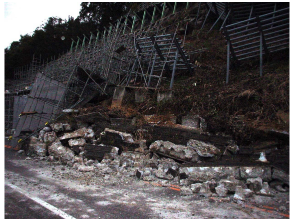
写真-4 一般国道17号川口町牛ヶ島 (262.5KP)でのブロック積擁壁の崩壊 (山側のブロック積擁壁が約20mにわたって崩壊)
