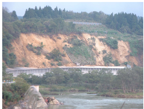
写真-6 県道333号中山竜光堀之内線 でのスノーシェルター上部の斜面崩壊 (国道17号が通行止めのため、緊急車両のみの代替ルートとなっている)
