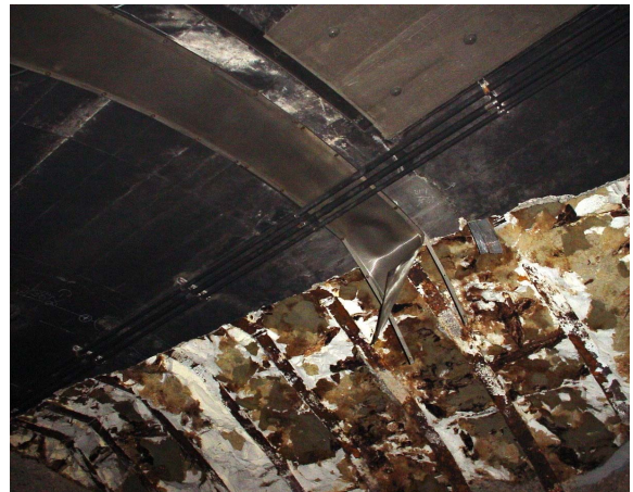
写真-2 一般国道17号和南津トンネル (覆工コンクリートが剥落した箇所では、鋼製支保工が露出している)
