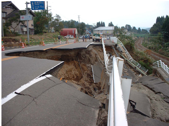
写真-3 一般国道17号川口町天納 (263.46KP)での道路崩壊(沢沿いで、幅約40mにわたってすべり破壊)
