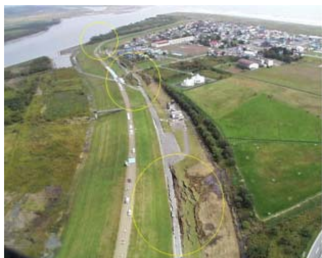
写真-1 十勝川右岸大津築堤 (提供:北海道開発局) 崩壊した堤内側の管理用道路
