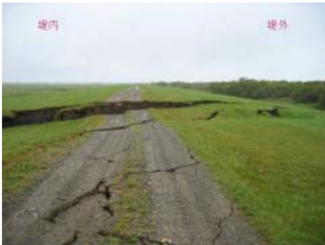
写真 - 3 十勝川左岸ウツナイ築堤（提供：北海道開発局） 横断方向に発生した亀裂・段差
