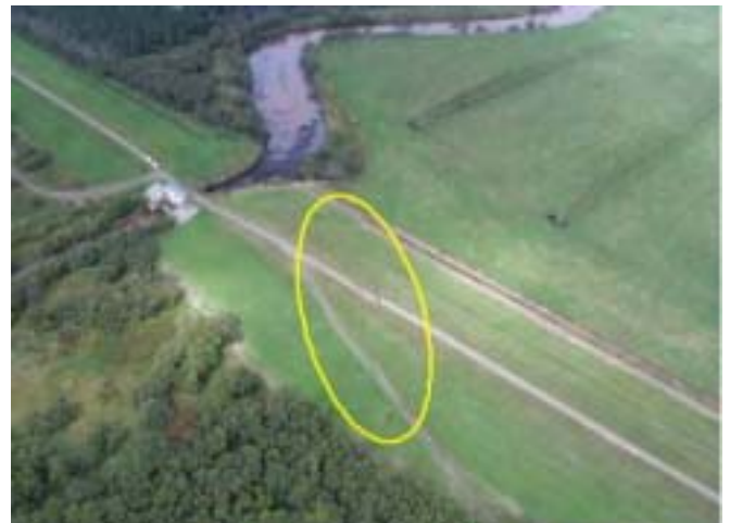
写真 - 4 十勝川左岸ウツナイ築堤（提供：北海道開発局） 旧河道にそって亀裂が発生した様子が見える
