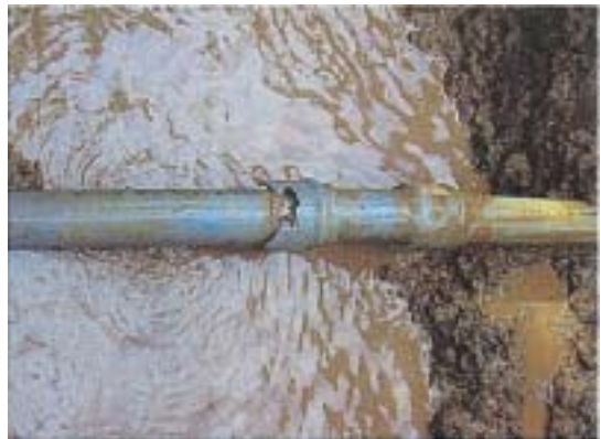
写真-2 75 VPのRR継手の破損
