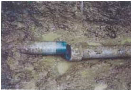
写真-3 150 ACPの継手の抜け
