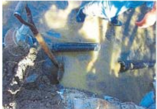
写真-1 75 DIPのT形継手の抜け
