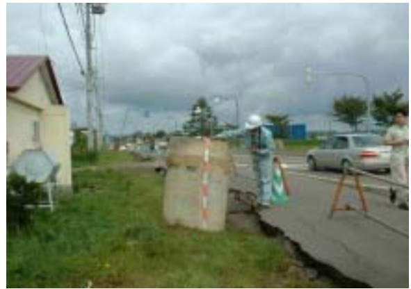
写真1 浮き上がったマンホール(音別町)
