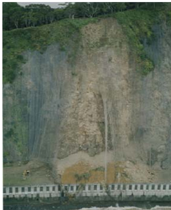
写真11 ほしば覆道上部の崩落(1)
