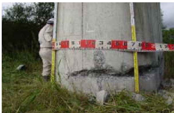
写真4 千代田大橋側径間部橋脚の被害（1）
