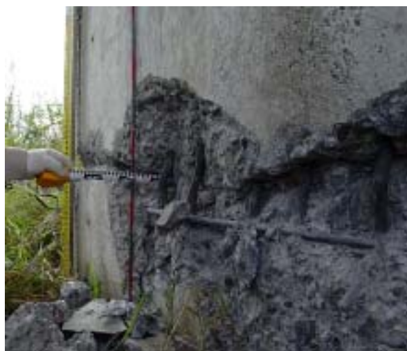
写真5 千代田大橋側径間部橋脚の被害（2）
