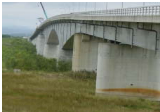
写真2 遠方左岸側の橋軸折れ曲り(十勝河口橋)
