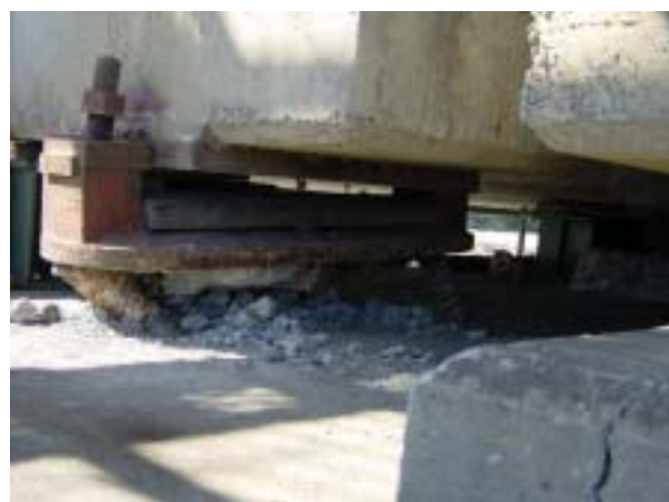
写真7 歴舟橋 アンカーボルトの浮き上がり
