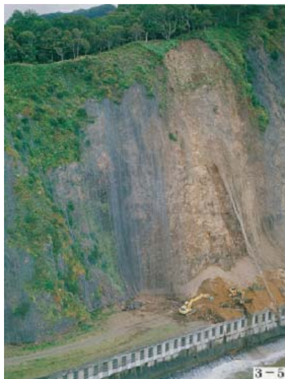
写真12 ほしば覆道上部の崩落(2)
