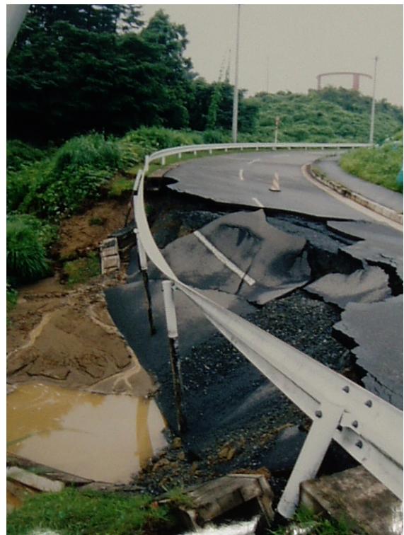
写真9.2 道路の陥没と高台の大塩配水池（右上）
