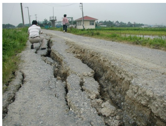
写真8.4 7月の地震による農道の被害
