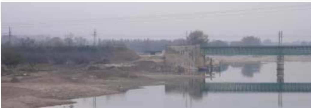
写真-4 鉄道橋の被災状況 (取り付け部の盛土が流出)
