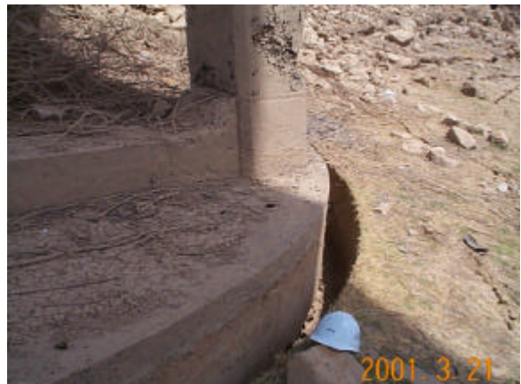
Photo 10 フーチングと地盤との間に生じた間隙
