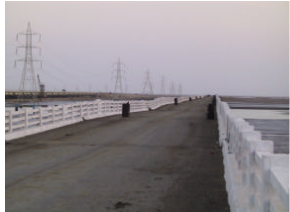
Photo 9 波打つように変形している Hadakia 橋の桁
