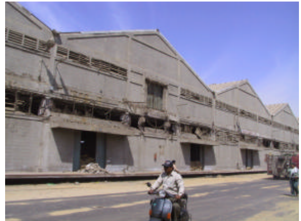
Photo 14 被害を受けた倉庫群
