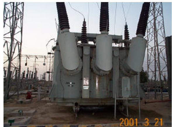
Photo 24 レールから脱輪した変電設備
