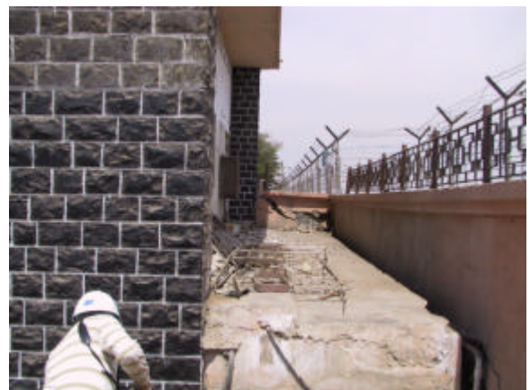
Photo 15 港湾ビル前面の被害
