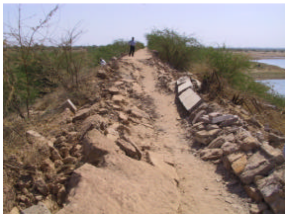
Photo 18 堤頂部の沈下
