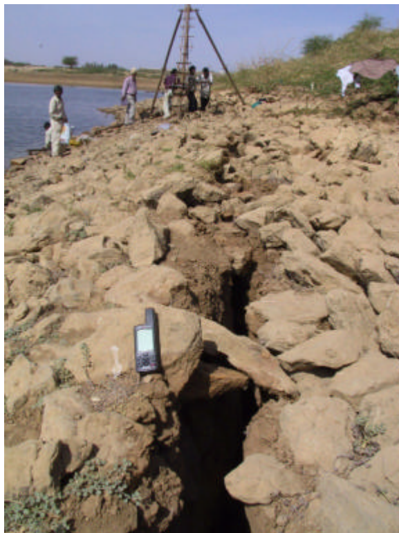
Photo 17 堤体下部の側方流動によるクラック
