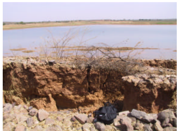
Photo 20 法面に生じたクラック
