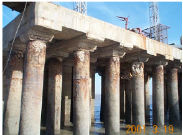
Photo 16 栈橋の杭の被害
