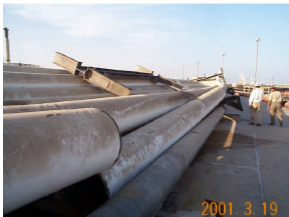
Photo 22 鋼製架構から崩れ落ちたパイプライン
