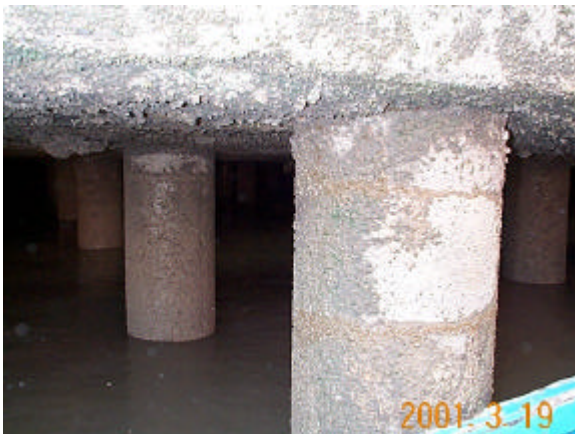
Photo 12 杭に生じた曲げクラック
