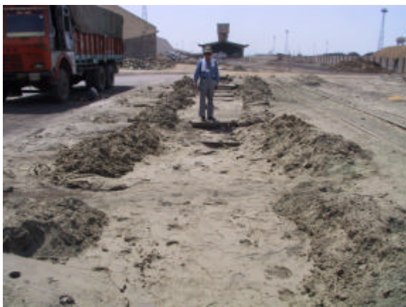
Photo 13 埋め立て部分の液状化跡
