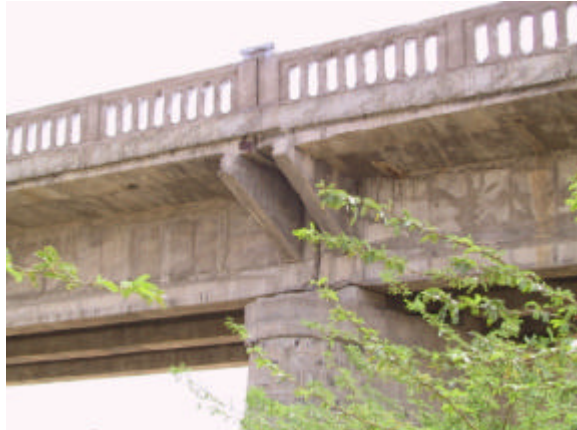
Photo 5 支障部の被害
