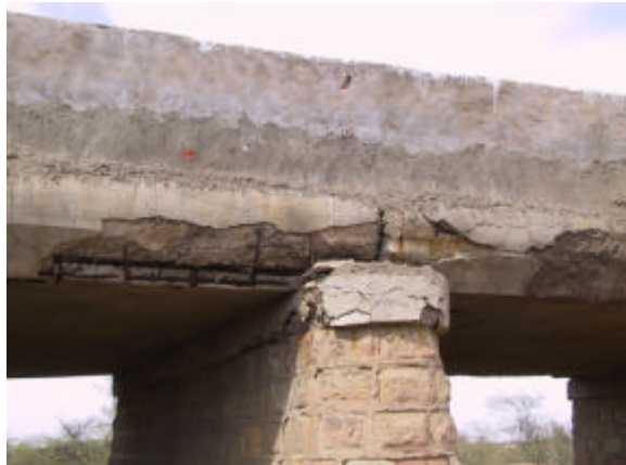
Photo 6 カンカワティ橋の被害
