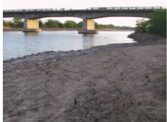
Photo 8 橋周辺に生じているクラックと液状化跡
