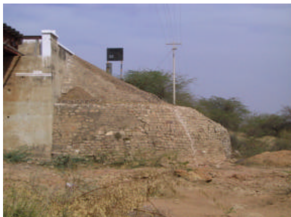
Photo 7 鉄道橋取り付け部レンガ擁壁の被害
