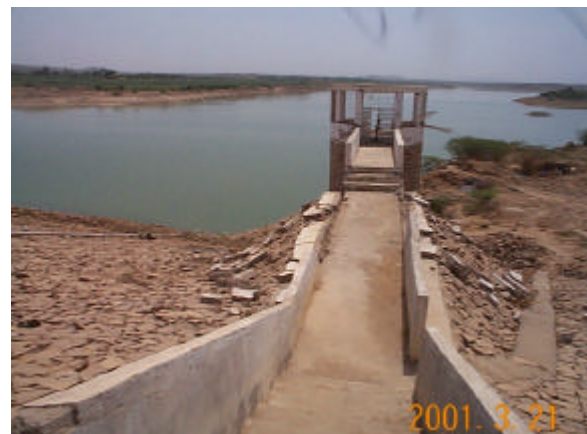
Photo 21 Rudermata ダムの取水塔周辺の被害
