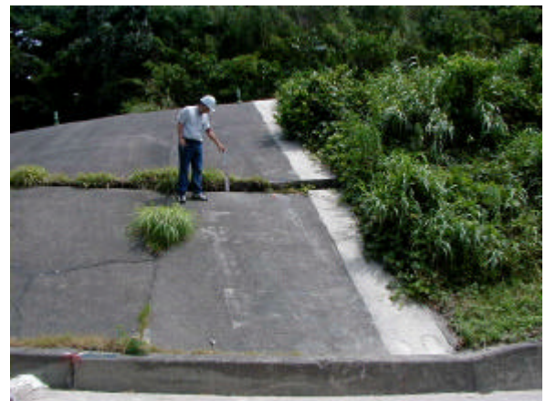
写真-6 上下道路の中間斜面の亀裂
