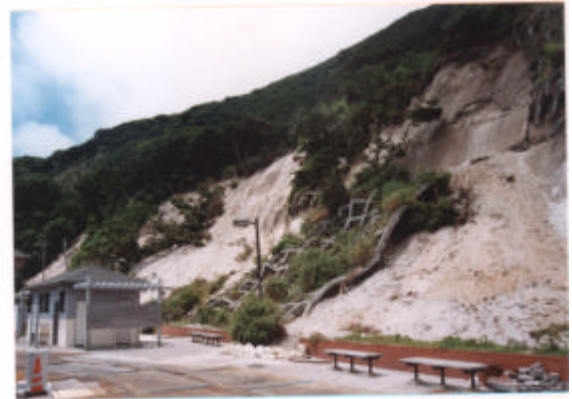
写真-5 のり枠工の崩壊
