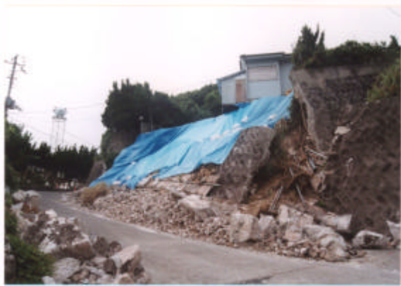
写真-7 石積擁壁の崩壊
