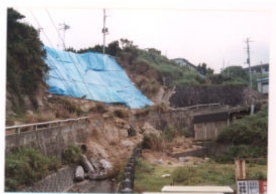
写真-2 人的被害箇所(神津島役場下の斜面崩壊)
