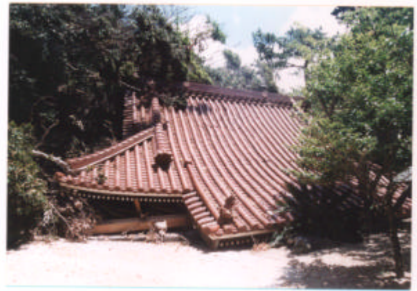
写真-8 物忌奈命神社の倒壊状況
