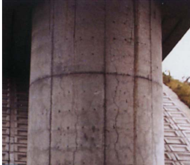
(最大ひび割れ幅：1.8 mm)
