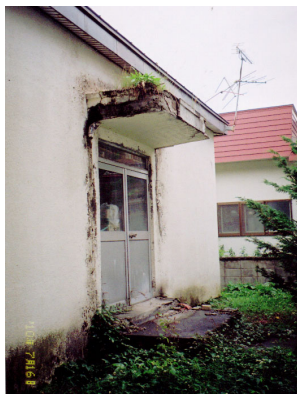
写真-2 同上。ボロボロに劣化した開口部周りと庇。如何にL. コルビュジェばりのデザインが日本の積雪寒冷地には通用しなかったかがよく分かる。
