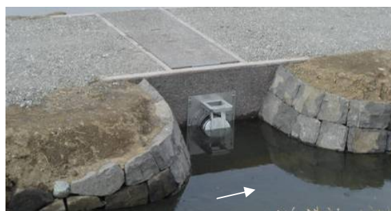
写真-17 湛水域と水路を接続する魚道のゲート部。
