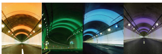
図-3 ランドマーク照明 (左から入口より2km, 3km, 4km, 5km)
