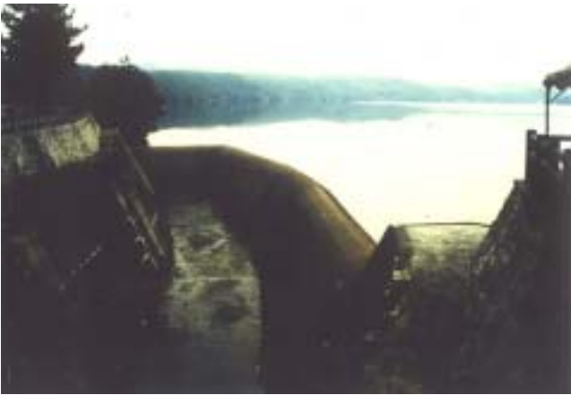
写真-4 ダム洪水吐き 空を拝む勾配+水環境の汚れ
