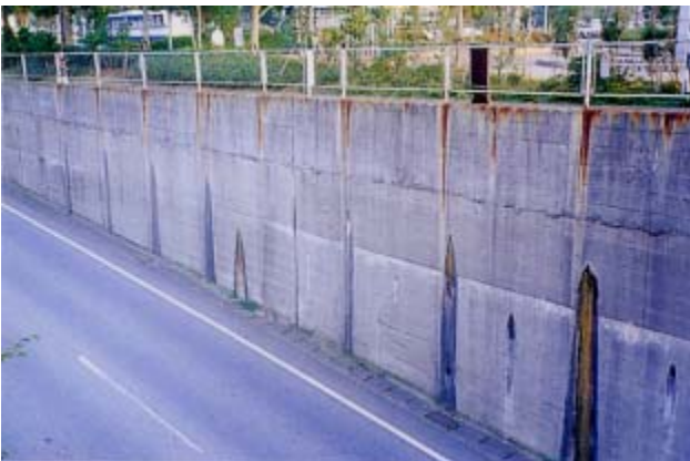
写真-5 擁壁の排水 擁壁の排水は、支柱からの伝い流れは、局所的な汚れとなりやすい。
