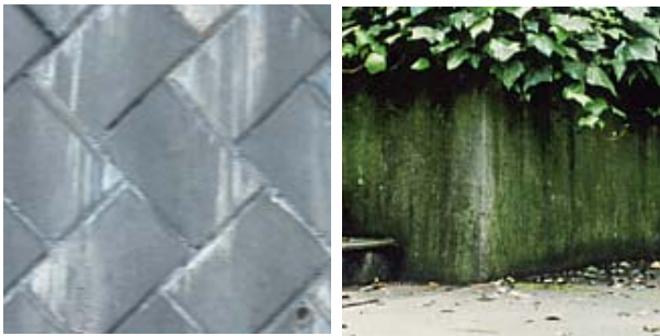
写真-1 コンクリート表面性状の変化 (左：化学的变化目地モルタルのエフ四レッセンス 右：樹木から放出された菌類の表面の付着)
