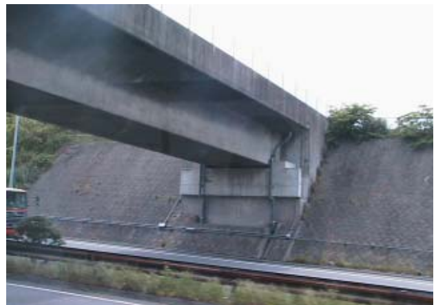
写真-2 高速道路の状況 (擁壁、橋梁など、全体が黒ずんでいる)
