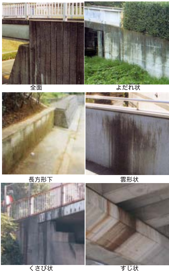
写真-5 コンクリートの汚れのパターン
