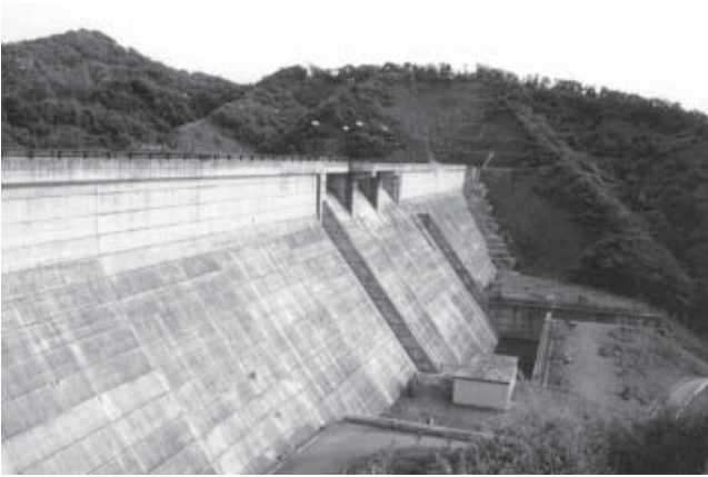
写真-3 ダム下流面 空を拝む勾配面と鉛直面の汚れの差
