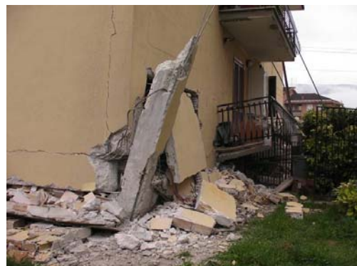
写真-114 層崩壊の様子 2
