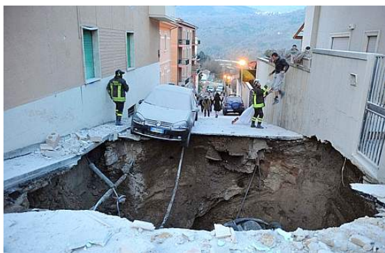
写真-10 自然空洞の崩壊による路面陥没
