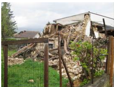
写真-87 組積造の崩壊
