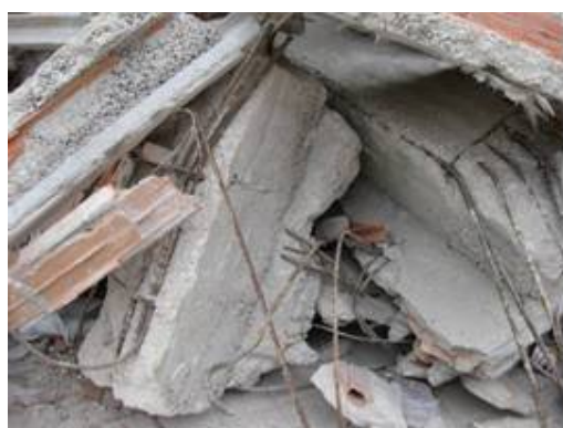
写真-74 寮崩壊付近のRC部材の残骸
