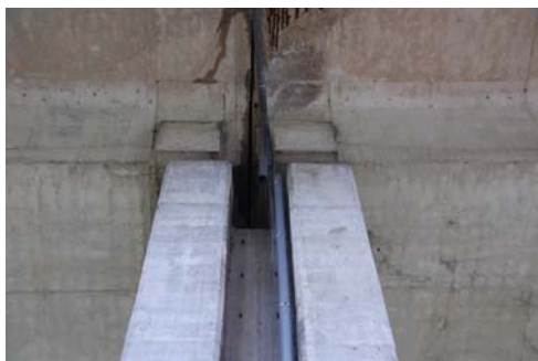
写真-153 橋軸方向への桁の残留移動
