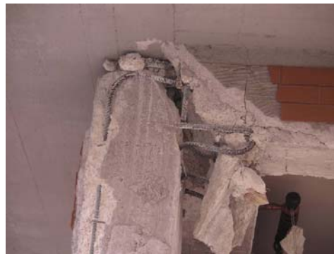
写真-112 柱梁接合部の破壊状況
