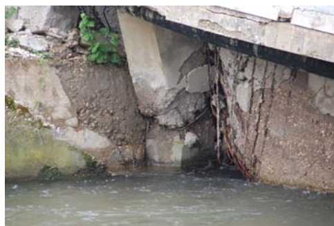
写真-136 パイルベント橋脚の損傷
