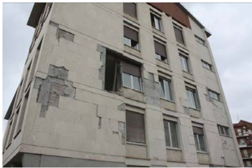
写真-59 仕上げ材の剥落(2)
