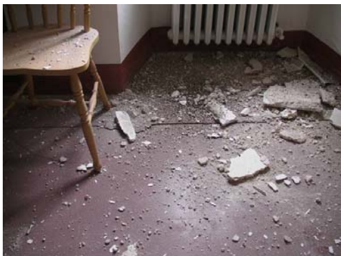
写真-125 床のひび割れ
