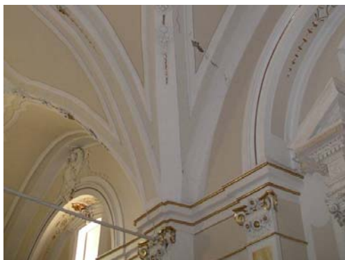
写真-129 ヴォールトのひび割れ
