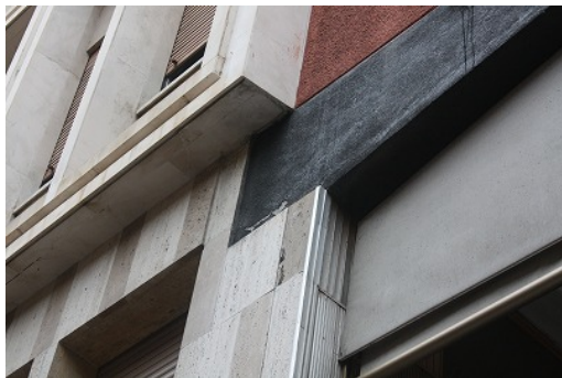
写真-41 梁のせん断ひび割れ (2)
