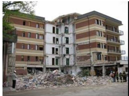
写真-69 学生寮の崩壊
