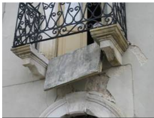
写真-80 バルコニーの石が割れている
