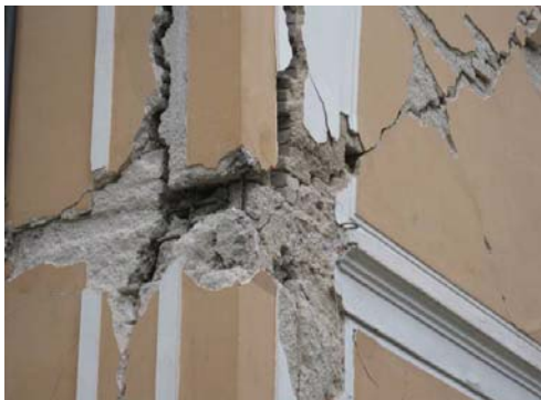
写真-63 接合部の破壊状況(3)
