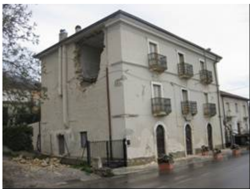
写真-79 組積造の外壁2階部分の崩落
