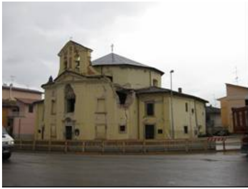
写真-89 教会の組積壁の崩落
