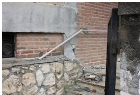
写真-102 柱脚部のせん断ひび割れ
