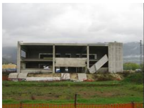
写真-85 建設中のPCa造工場の被害
