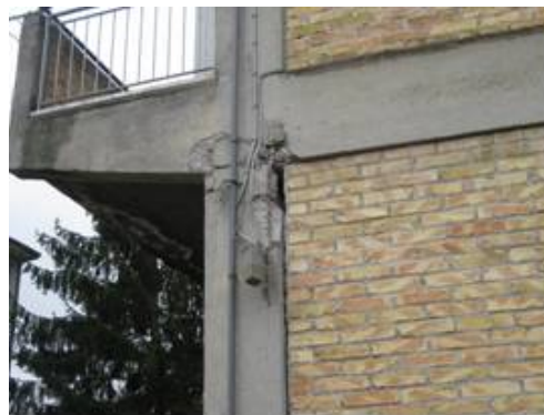
写真-100 柱頭部の接合部にひび割れ
