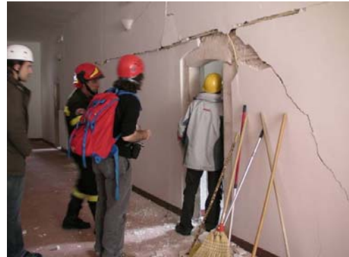
写真-124 壁のひび割れ
