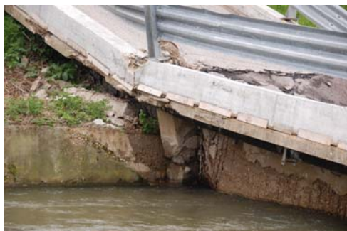
写真-133 パイルベント橋脚の損傷
