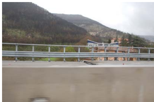
写真-151 桁端部に生じたギャップ
