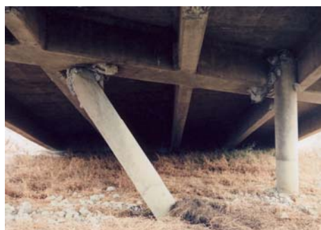
写真-140 地盤の支持力不足のため大きく変形し、破断した桁との固定部
