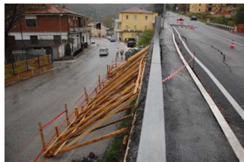
写真-159 沈下した路面
