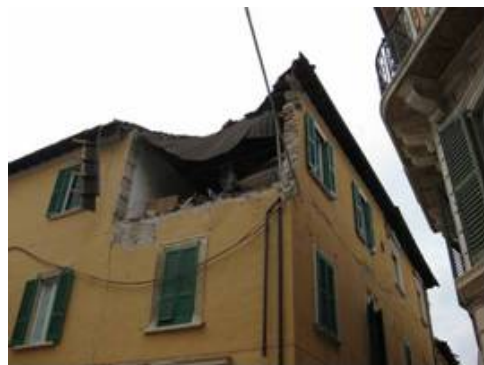
写真-31 組積造 3 階部分の外壁が崩落
