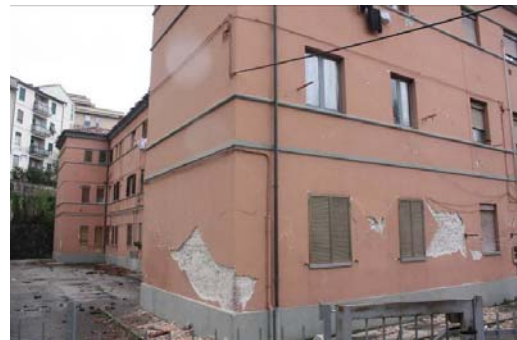
写真-64 壁の被害／柱は煉瓦、壁は石積(6)
