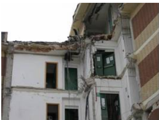
写真-70 増築部分の梁鉄筋が露出
