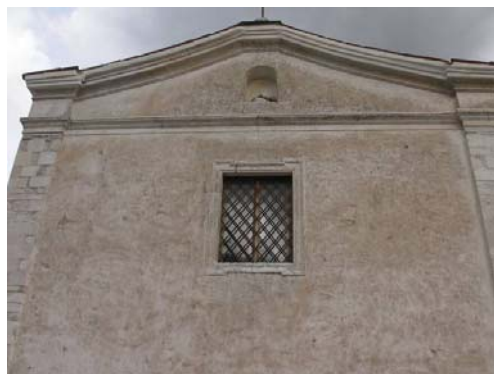
写真-130 ファサードのひび割れ
