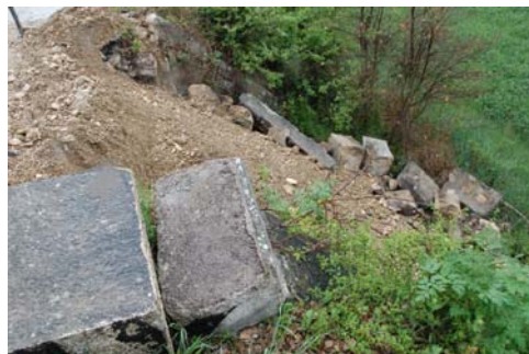
写真-146 散在する石造アーチ主構部材
