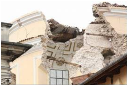
写真-20 崩壊したドーム
