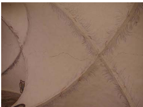
写真-127 ヴォールトのひび割れ
