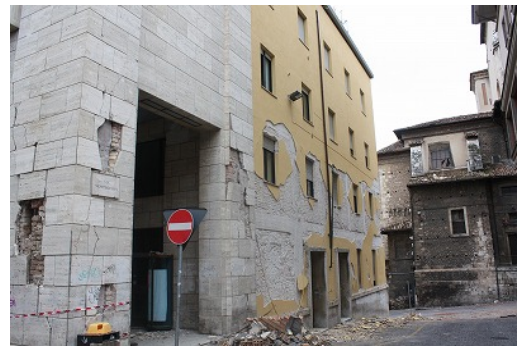
写真-48 建物側面の仕上げ部の剥落(5)
