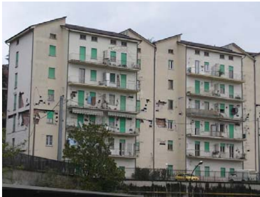
写真-67 3階、4階での被害が目立つ(5)
