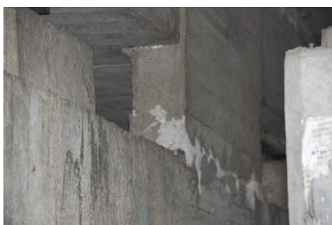
写真-157 せん断キーの損傷
