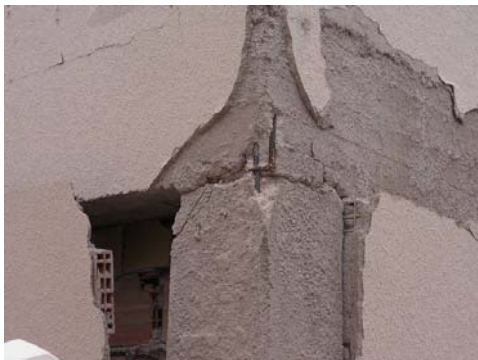
写真-111 柱頭の破壊状況
