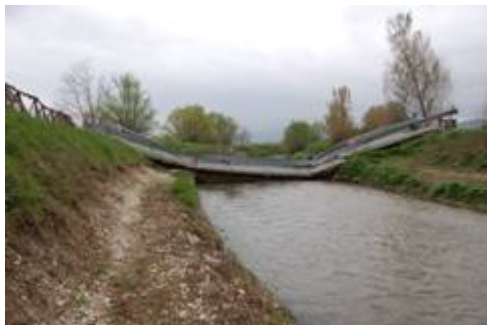
写真-131 3 径間連続橋の落橋（Fossa 駅近く）
