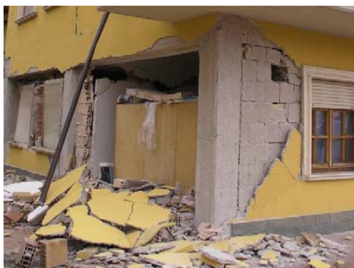
写真-117 煉瓦ブロック壁の面外崩壊
