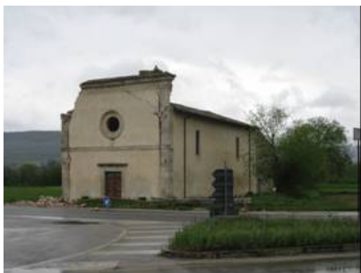
写真-77 余震による組積造教会の破損
