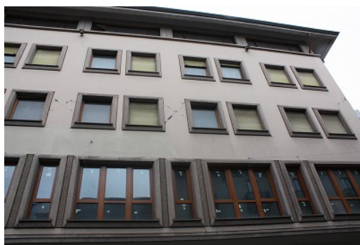
写真-45 柱のせん断ひび割れ(4)
