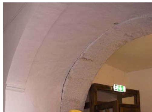
写真-128 アーチのずれ
