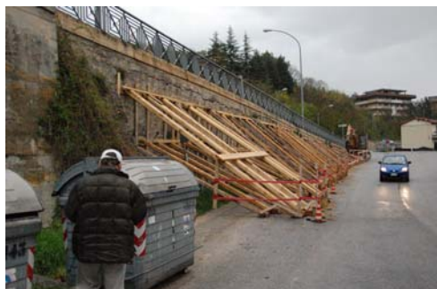
写真-158 盛土の変形とこれに対する応急復旧
