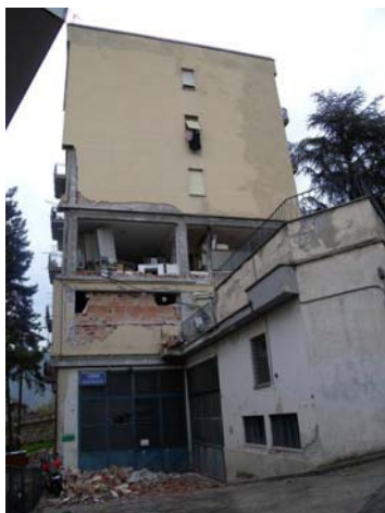
写真-65 空洞煉瓦壁の崩落／柱断面が2階、4階でしばられている(4)
