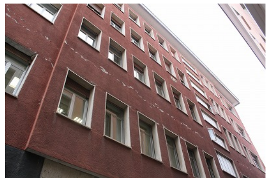
写真-38 壁のひび割れ（2,3階境界位置）(2)
