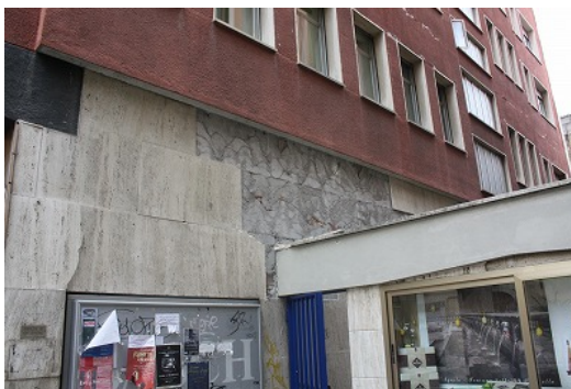
写真-37 鉄骨埋め込み部周辺の損傷(2)
