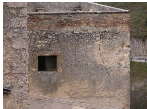
写真-126 バルコニーのひび割れ
