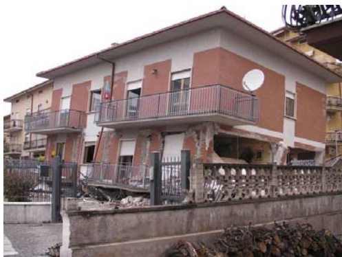
写真-113 層崩壊の様子 1
