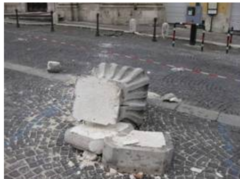
写真-21 教会の落下物
