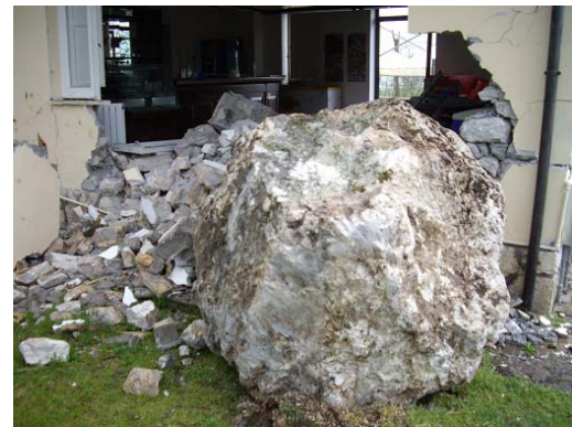
写真-7 公園最下部の建物の壁を直撃破壊した落石
