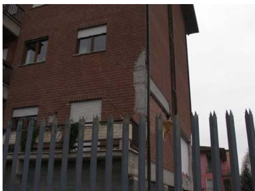
写真-119 開口部間のせん断ひび割れ
