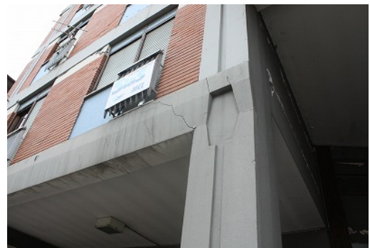
写真-52 2階床梁のせん断ひび割れ(8)
