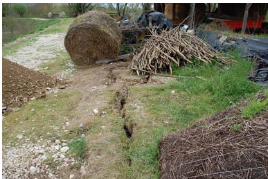
写真-2 Aterno 川堤体に生じたクラック
