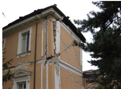
写真-62 壁が面外方向に傾斜(3)
