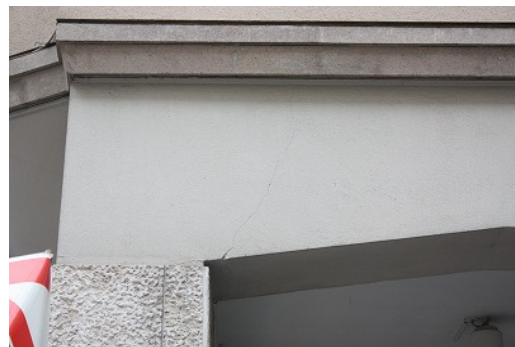
写真-44 梁のひび割れ（曲げひび割れ）(4)
