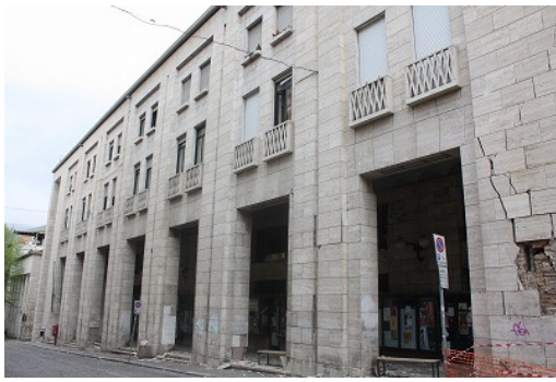
写真-47 柱のふかし部の損傷と柱脚タイトルの剥落(5)
