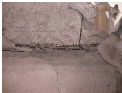
写真-116 鉄筋腐食
