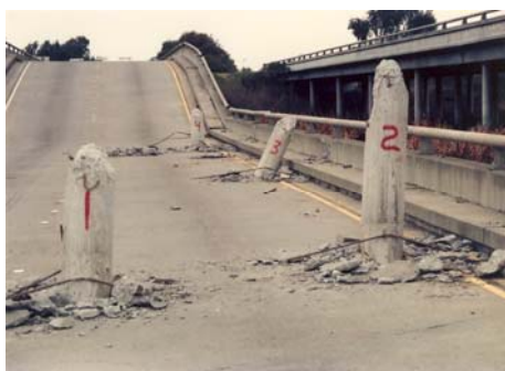
写真-139 パンチングシアにより床版上に突き出したパイルベント橋脚頭部
