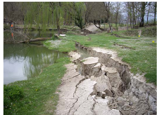
写真-4 土塊が池側に流動
