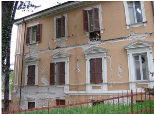
写真-61 長辺方向の損傷状況(3)
