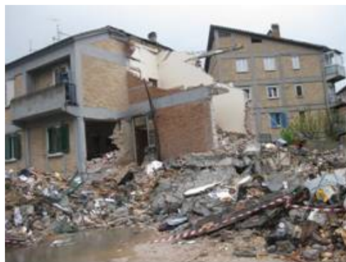
写真-98 低層RC造の崩壊
