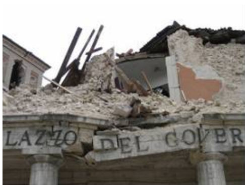
写真-34 組積造 PLAZZO DEL GOVERNO の崩壊
