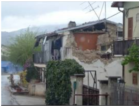
写真-93 石積+土目地壁の崩壊
