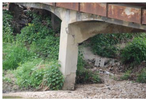
写真-142 RC ラーメン橋脚の損傷
