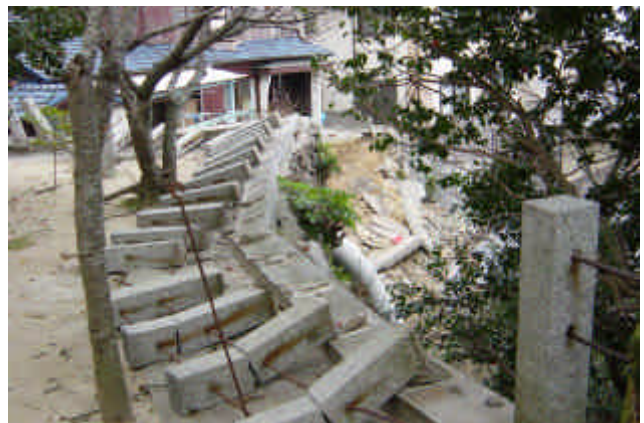
写真 12.2.23 小鷹神社の石造柵の崩壊
