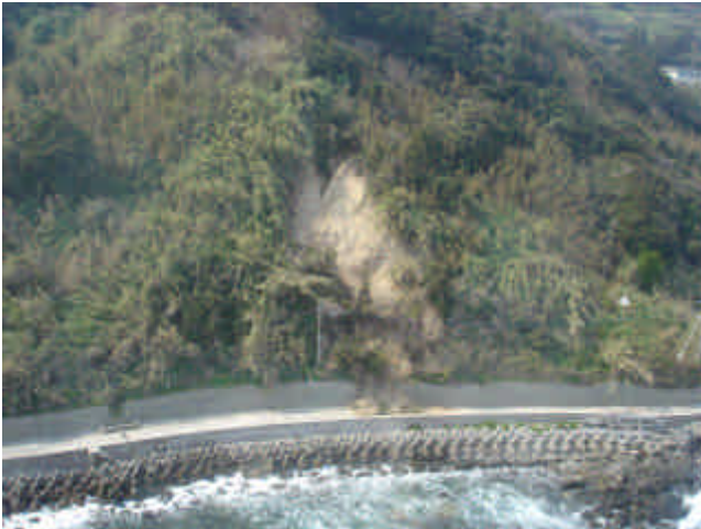
写真 12.2.26 島東側の斜面崩壊Ⅰ（空撮）
