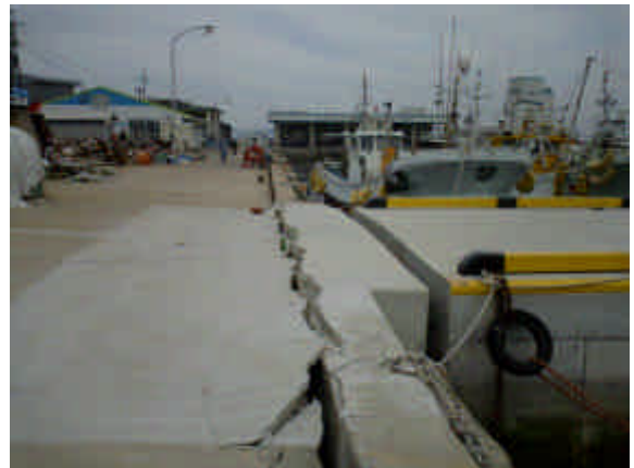
写真 12.2.7 岸壁のはらみだしと沈下
