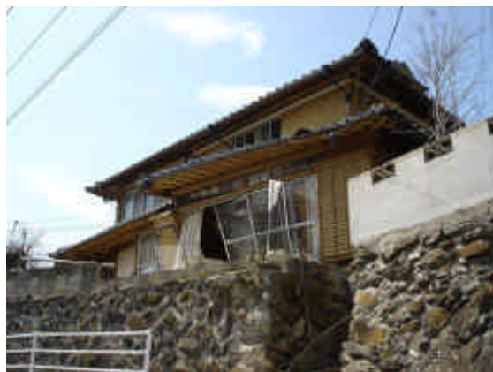
写真 12.2.13 健全な擁壁と損壊家屋
