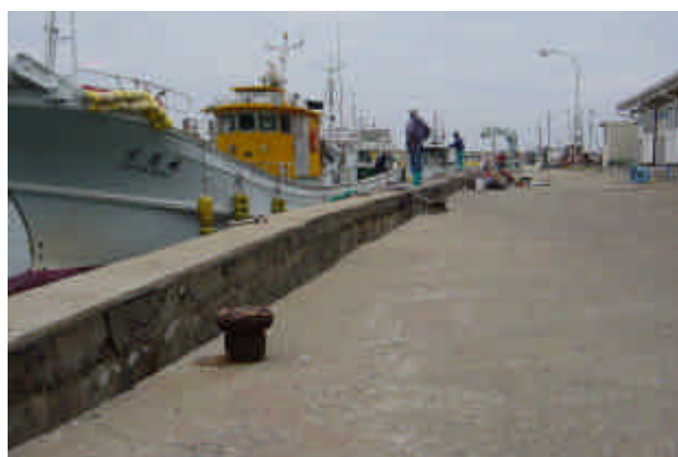
写真 12.2.5 岸壁のはらみだしと沈下
