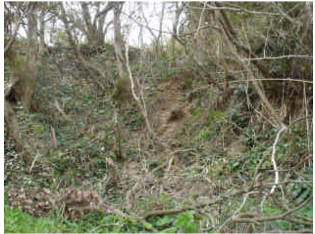
写真 12.2.19 玄界中学校裏の斜面崩壊
