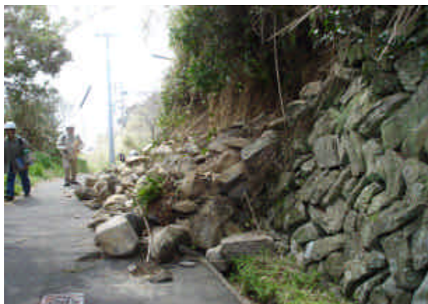
写真 12.2.2 道路に対する石積みの流出 (⑥番)
