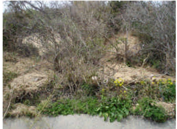
写真 12.2.25 道路脇の斜面崩壊
