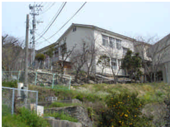
写真 12.2.14 玄界小学校と校庭石積みの崩壊
