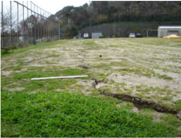
写真 12.2.18 玄界中学校のグラウンド亀裂
