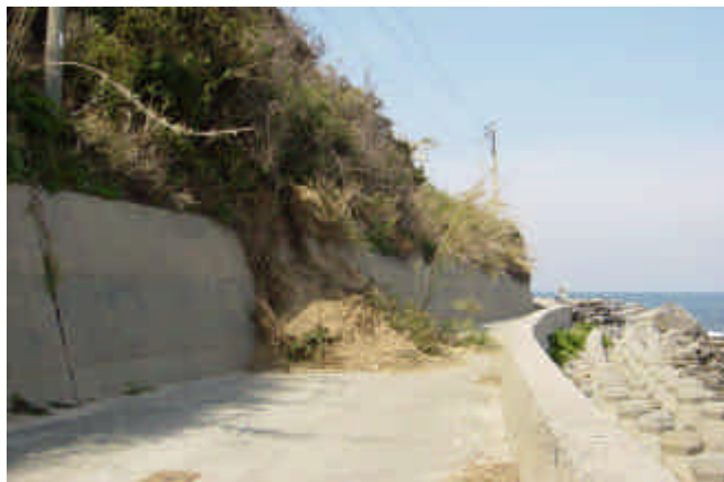
写真 12.2.1 道路に対する土砂流出 (⑤番)
