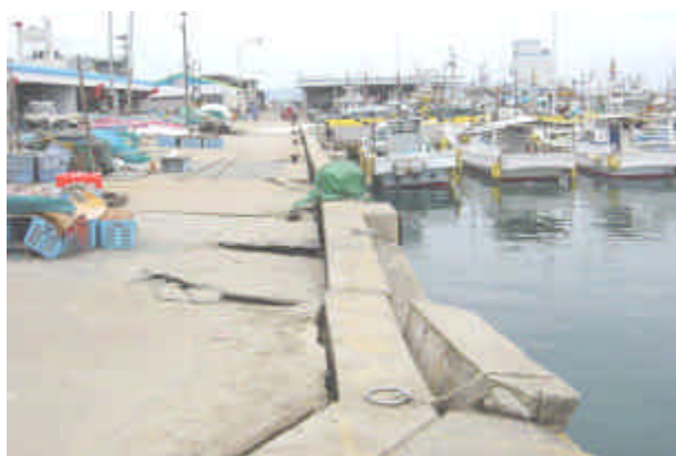
写真 12.2.4 岸壁のはらみだしと沈下
