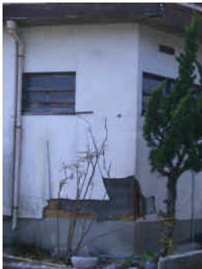
図-10.4.17 隅角部の亀裂とモルタル落下 宮浦
