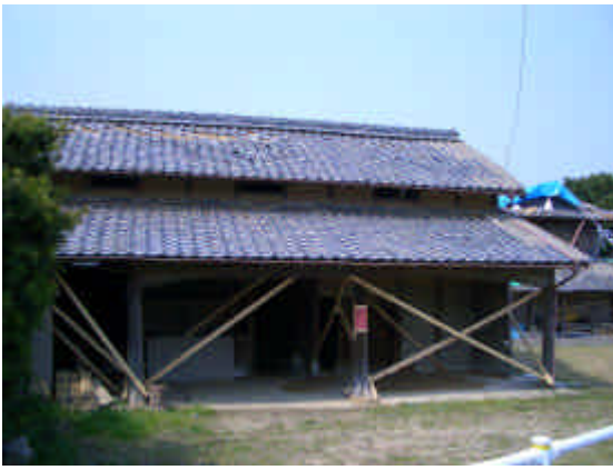
図-10.4.1 倒壊の恐れがある木造住宅 西浦
