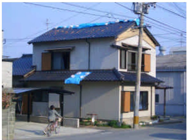
図-10.5.16 屋根の被害 志賀
