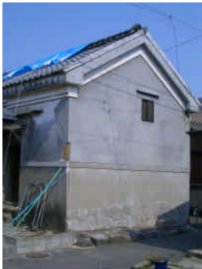
図-10.5.3 蔵の隅角部の被害 弘
