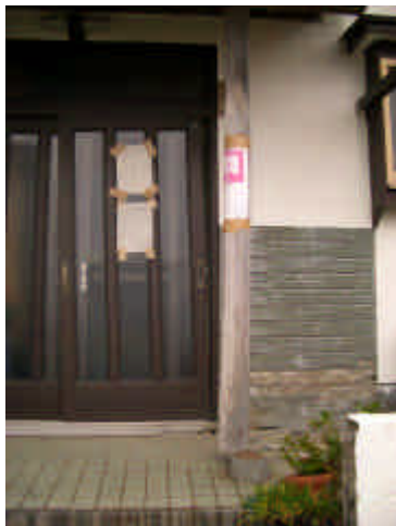
図-10.3.7 玄関の柱が基礎から移動した住宅 玄界島
