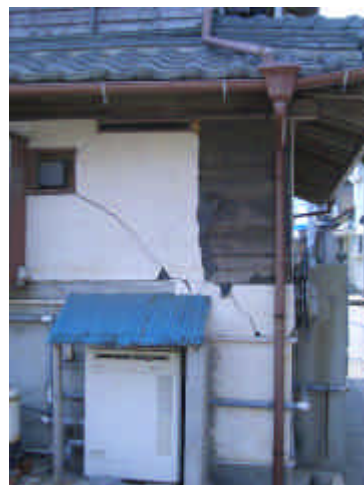
図-10.4.6 壁の大きな亀裂と落下 西浦
