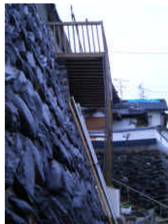
図-10.3.18 ベランダの支柱の変形 玄界島
