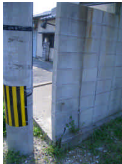
図-10.5.8 ブロック塀の亀裂 勝馬
