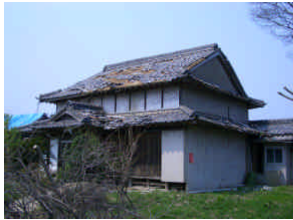
図-10.4.2 木造住宅の屋根の被害 西浦
