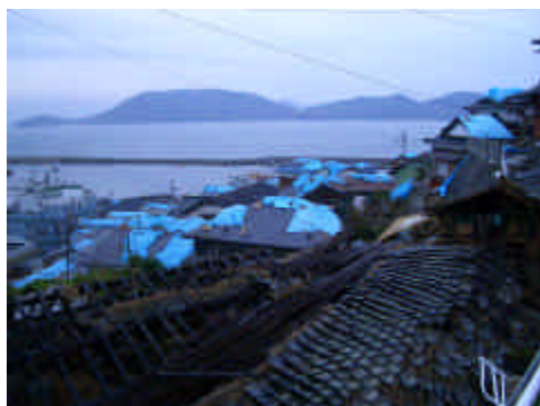
図-10.3.9 ブルーシートは屋根の被害 玄界島
