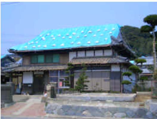
図-10.4.9 木造住宅の屋根の被害 宮浦
