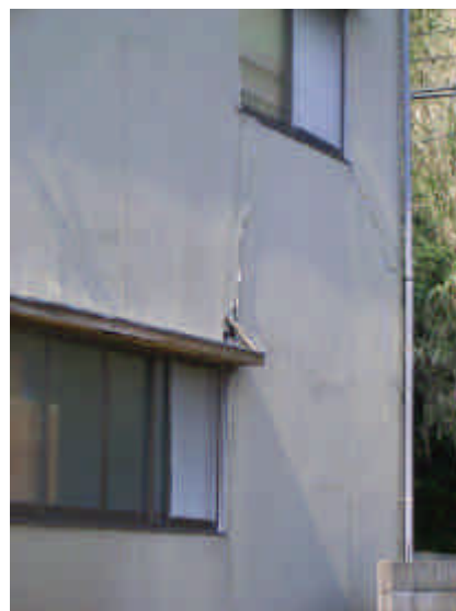
図-10.5.6 外壁に入った亀裂 弘
