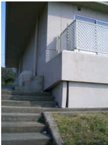
図-10.5.7 地盤との接合部の亀裂 勝馬
