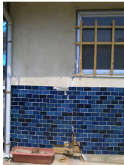
図-10.4.4 鉛直方向の壁の亀裂 西浦
