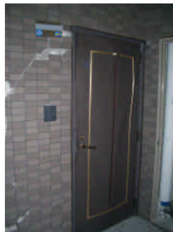
図-10.2.4 面外変形した扉
