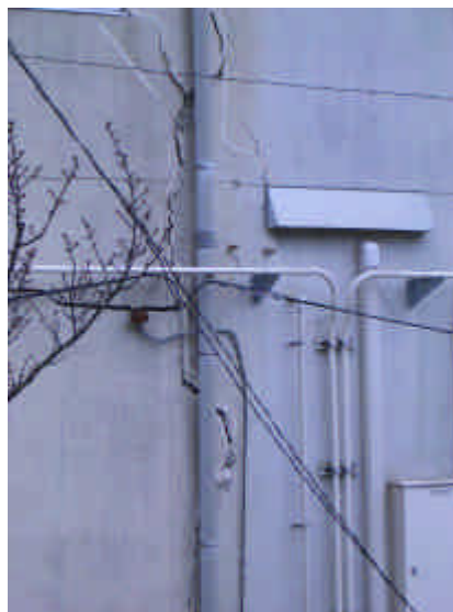
図-10.3.12 玄界小学校 壁に鉛直方向の亀裂
