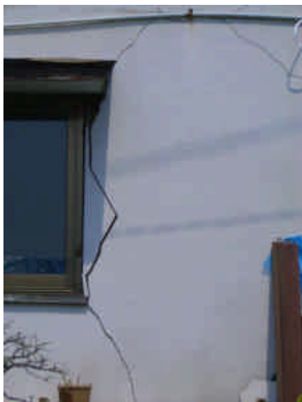
図-10.4.11 開口部から伸びた亀裂 宮浦
