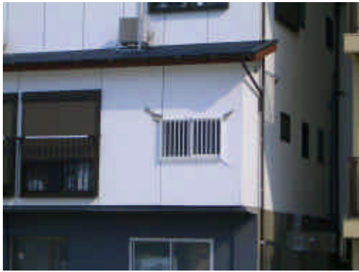
図-10.5.13 開口部から生じた亀裂 勝馬
