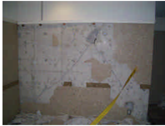
図-10.2.2 エレベータホールの壁のせん断亀裂
