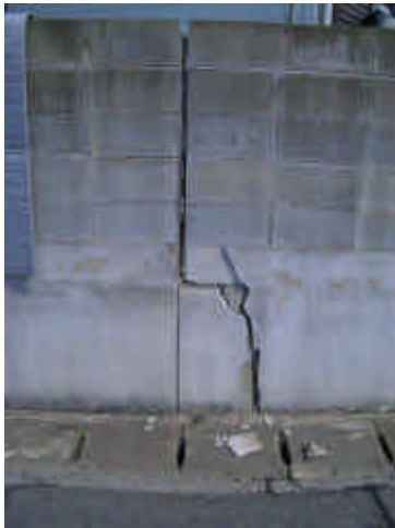
図-10.4.7 ブロック塀の損傷 西浦
