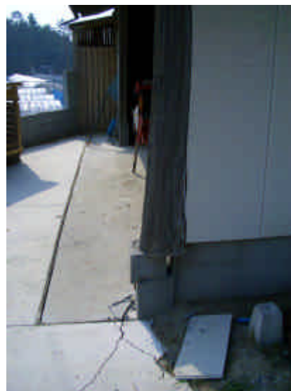
図-10.5.10 柱が移動した木造倉庫 勝馬
