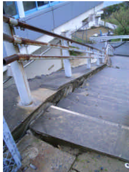
図-10.3.2 玄界中学校 階段部の損傷
