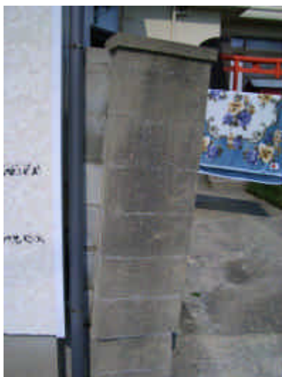
図-10.5.5 蔵の傾斜したブロック塀 弘
