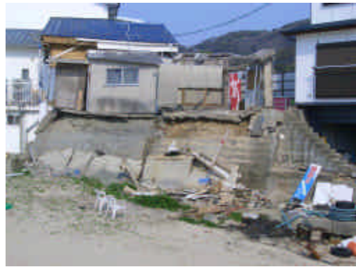
図-10.5.14 ブロック塀の倒壊 勝馬
