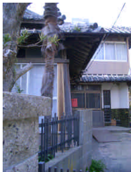
図-10.5.18 柱が傾いた木造家屋 志賀
