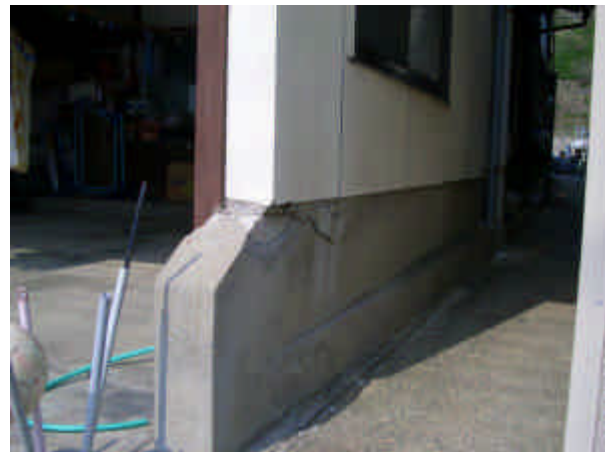
図-10.5.4 壁の接合部の損傷 弘
