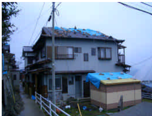
図-10.3.10 屋根が被害を受けた住宅 玄界島
