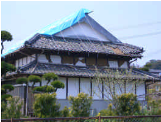
図-10.4.15 屋根と外壁の被害 宮浦
