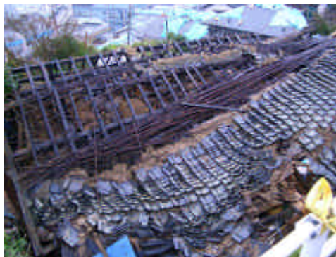
図-10.3.8 倒壊した木造倉庫 玄界島
