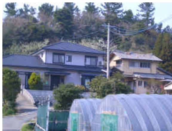
図-10.5.12 屋根の被害，左の新しい住宅は無被害 勝馬
