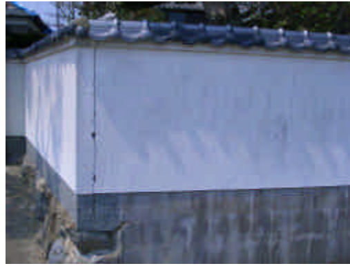
図-10.4.14 塀の隅角部の亀裂 宮浦
