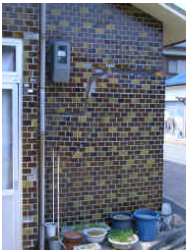
図-10.4.5 壁の大きな亀裂 西浦
