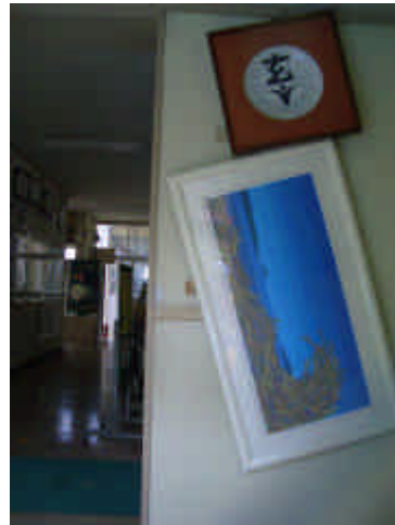
図-10.3.14 玄界小学校 激しい揺れの痕跡
