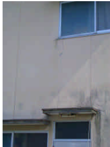
図-10.5.2 壁に鉛直方向に入った亀裂 弘
