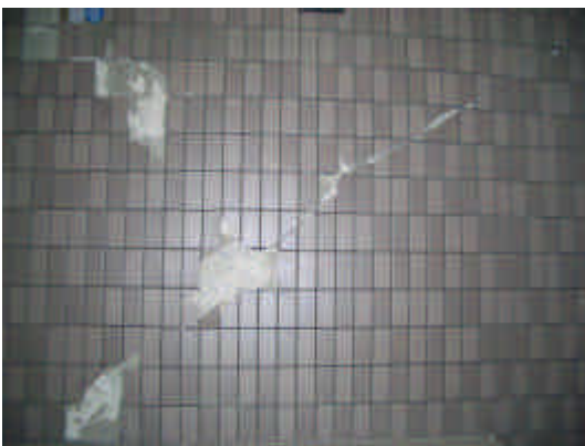
図-10.2.3 住居部分の壁のせん断亀裂
