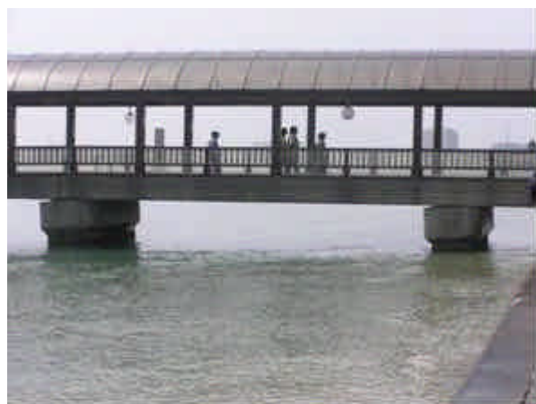
(a) 橋脚の傾き
