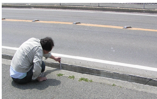
(a) 橋脚のずれ
