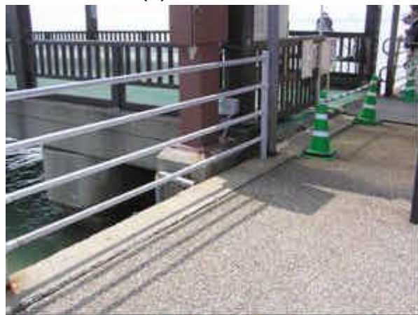
(c) 桁と橋台の連結部の段差
