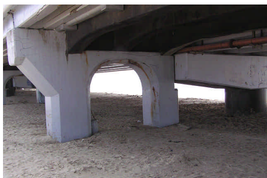
(c) 橋脚の衝突
