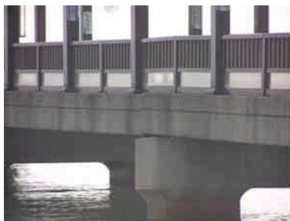
(b) 桁の浮き上がり
