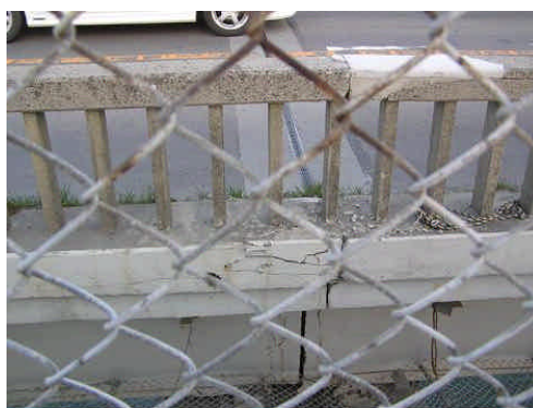
(b) 桁の衝突による損傷（第 2 径間と第 3 径間）
