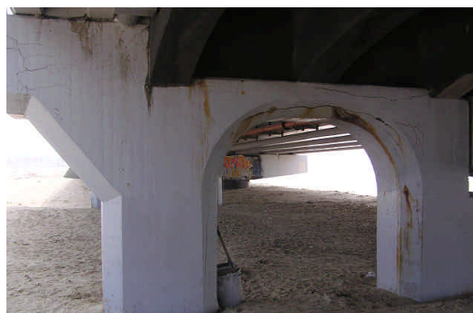
(b) 橋脚のひび割れ
