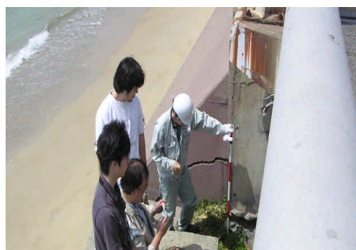
(d) 沈下による橋台のずれ
