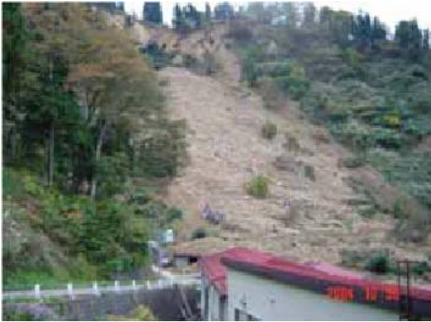
図7.28 羽黒トンネル西側坑口南寄り上部の斜面崩壊
