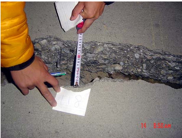
図7.18 木沢トンネル内床版の亀裂開口（北側坑口より230m）
