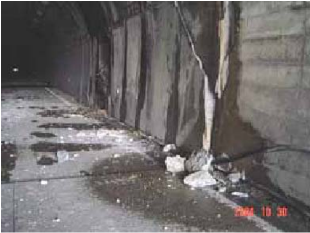
図7.24 羽黒トンネル西側坑口付近南側側壁の被害状況
