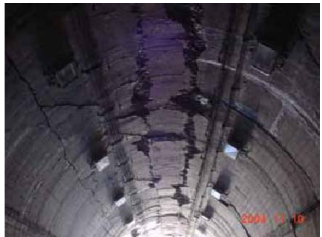
図7.27 東側坑口付近のアーチコンクリートの被害状況 (トンネル内部から坑口に向う)
