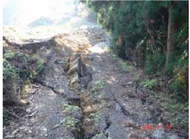
図7.30 羽黒トンネル上部地山の峰部からやや西側斜面の側に見られた段差1.5m，総計開口幅1mの開口亀裂
