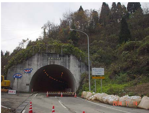
図7.14 木沢トンネル北側坑口：坑口から30～80m区間の覆工側壁部に損傷が見られる。トンネル背後の樹木に被覆された尾根の後ろがその距離に対応する。
