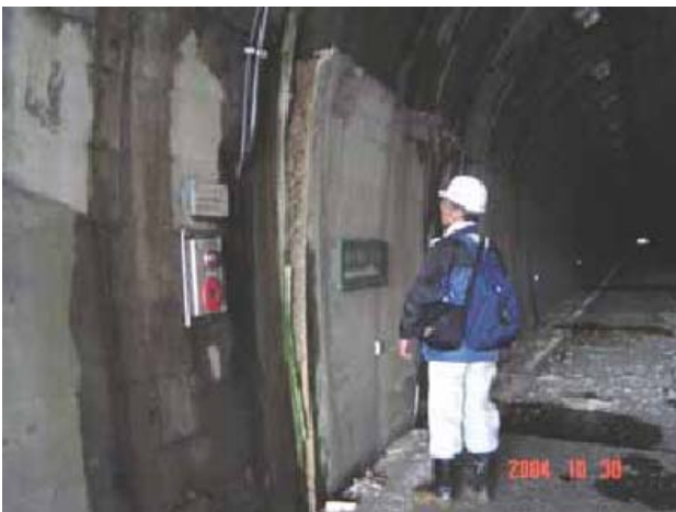
図7.25 西側坑口付近のアーチコンクリートの被害状況 (坑口からトンネル内部に向う)
