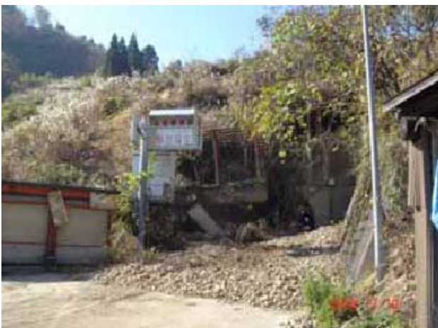
図7.29 羽黒トンネル東側坑口上部の斜面崩壊と坑口での土砂堆積
