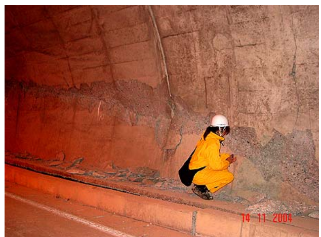
図7.16 東側側壁の圧壊：東側の壁は地山側に40cmほど押し出している。
