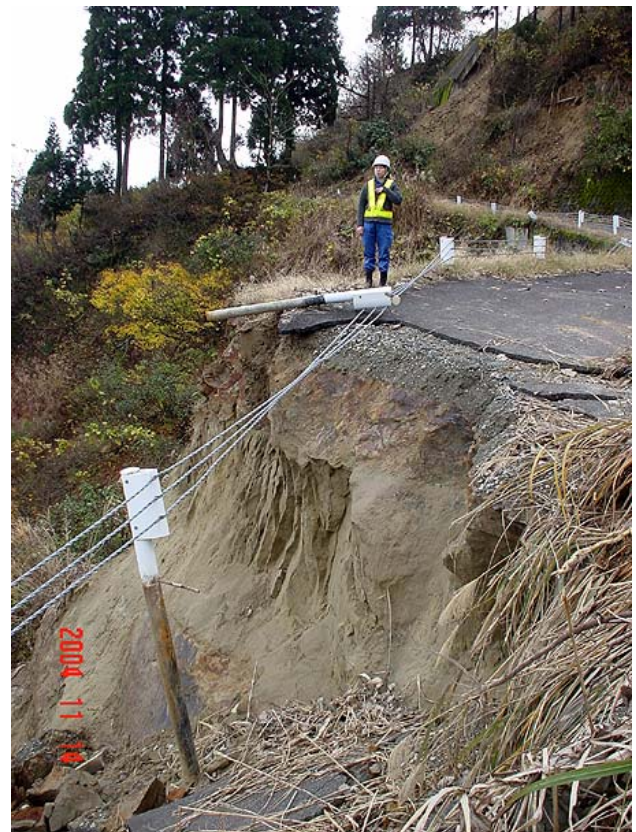
図7.11 木沢トンネルに沿う東側斜面の状況：南南東を向いての撮影。人物（木沢トンネル北側坑口より62m南）手前の滑落面の露出した砂層の厚さはおよそ2m。地層の傾斜はほぼ南西方向に15～20°程度と見られるので、実際の層厚もほぼ同じ程度と思われる。人物の後ろに谷地形（黄色矢印）上部に旧地滑り跡（図7.10の破線A。後述の図7.13）。
