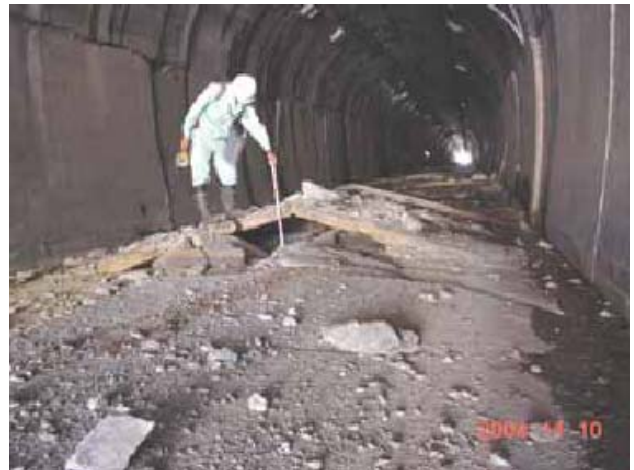
図7.26 羽黒トンネル東側坑口付近の道路面および側壁コンクリートの被害状況
