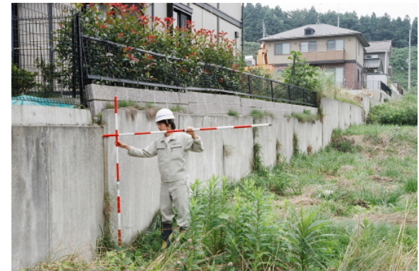
写真 7.4 矢本町緑ヶ丘団地：L型擁壁の被害
