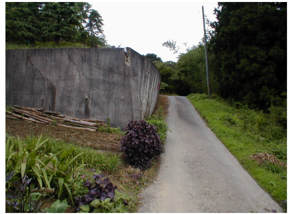
写真 7.3 河南町北村地区：宅地盛土擁壁の被害
