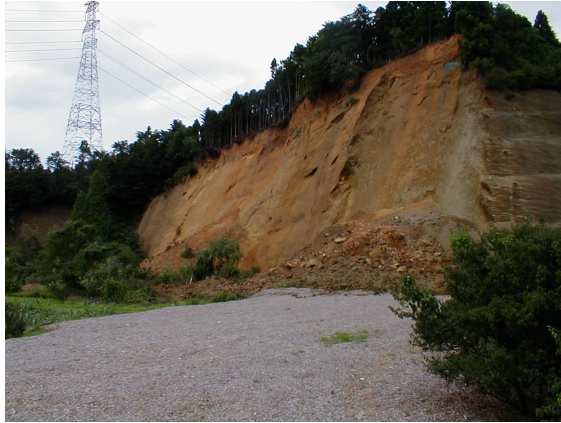
写真 7.1 矢本町大塩地区：風化した切土表層の崩落
