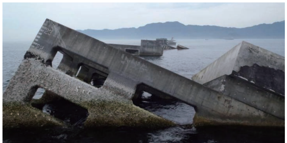
写真3 釜石湾口防波堤が津波により破壊された様子（2011年6月20日撮影）
