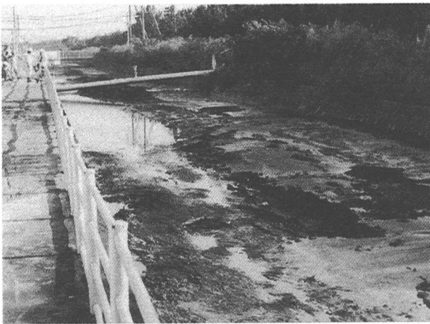
写真-2 承水路での噴砂
