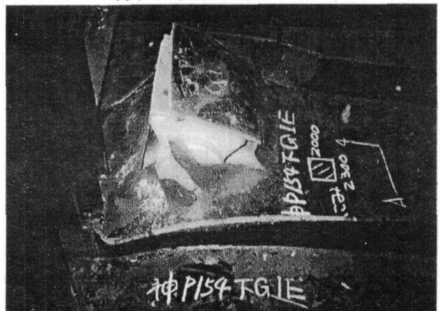
写真-2 支承の下フランジ貫通例
