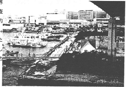
写真-1 ポートアイランド 北公園東側岸壁の被害
