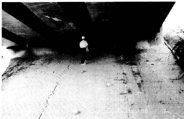
写真-12 No.4橋梁の損傷状況
