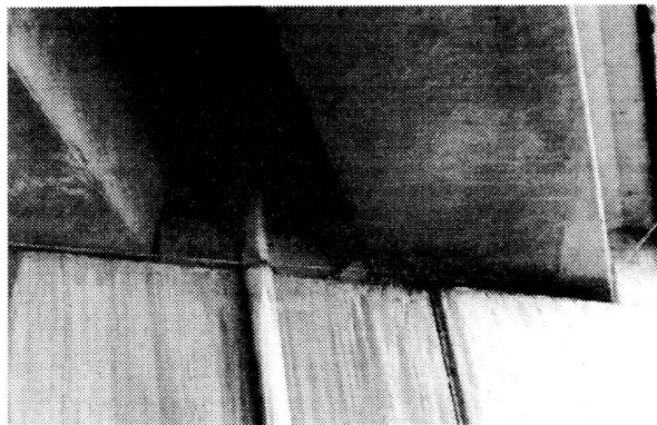
写真-10 No.2橋梁の橋台支承部の損傷
