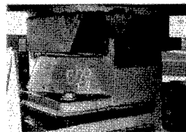
(a) P70 支承の損傷
