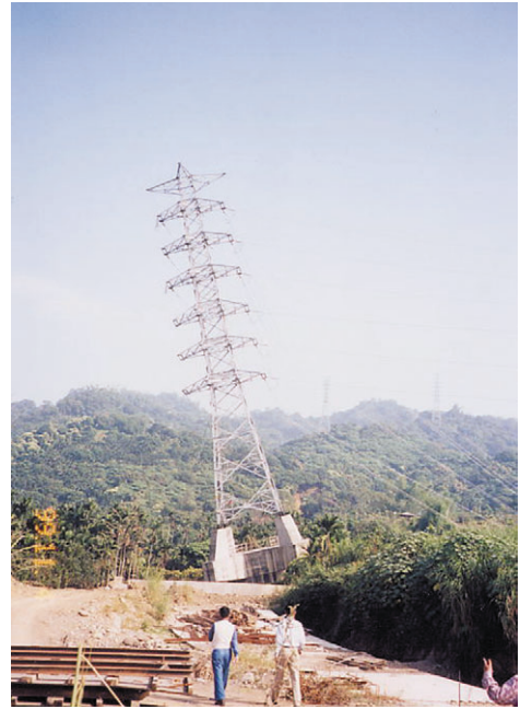
写真-3 台湾・集集地震で発生した断層上にあった送電鉄塔（鉄塔下の右半分の地盤が持ち上がったが鉄塔は基礎が強く傾いただけで崩壊しなかった）
