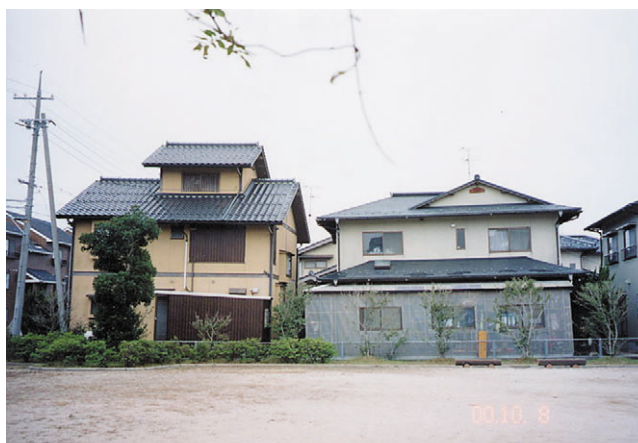
写真-1 鳥取県西部地震の際に液状化によって傾いた家屋
