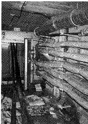
写真-1 開削式とう道の伸縮継手部の被災状況
