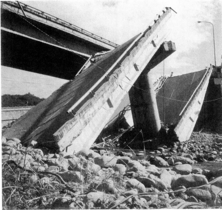
図-9.8 損傷状況写真
