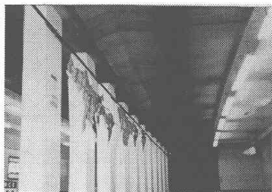
写真-2.3.2 高速長田駅の中柱のせん断破壊 (下り線ホームより東方・大開方面を見る)
