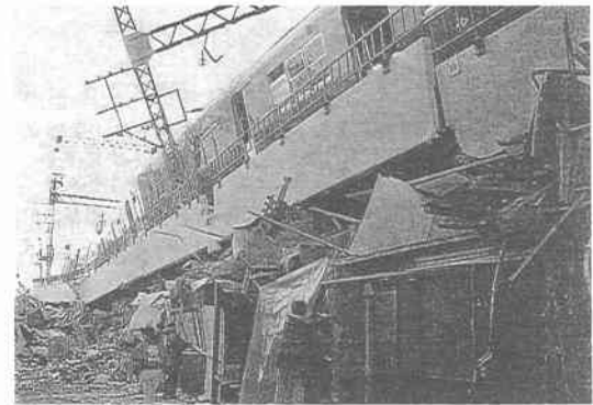
写真-1.1.8 鉄道高架橋の被害（その4）
