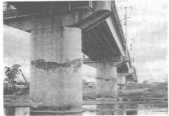
写真-1.1.6 鉄道高架橋の被害（その2）
