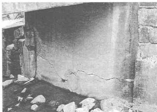
写真-1.1.9 小規模橋梁橋台における水平及び鉛直ひび割れ損傷の例
