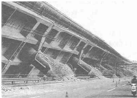
写真-1.1.1 橋脚倒壊部（ピッツ橋脚）
