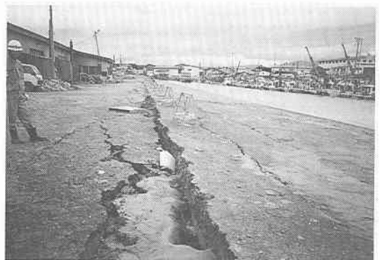
写真 10.4.8 森港第 1 澗内物揚場 (-4.0 m) 被災状況
