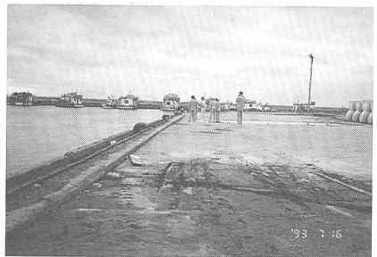
写真 10.4.5 森港中央埠頭-4.5 m 岸壁被災状況
