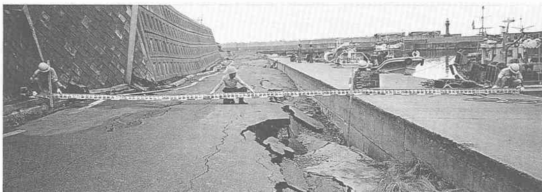
写真 10.7.2 須築漁港-4.5 m 岸壁被災状況
