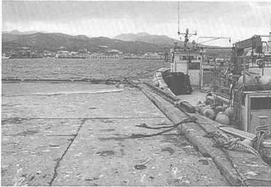
写真 10.4.6 森港中央埠頭岸壁取付先端部被災状況 (矢板式構造区間)
