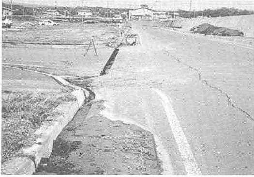
写真 10.4.1 森港西防波護岸背後の被災状況 （矢板式構造区間）
