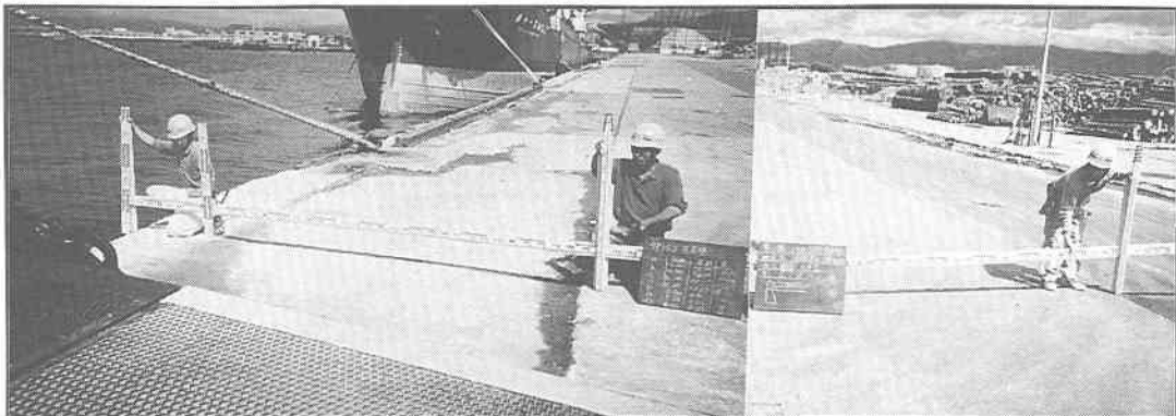
写真 10.3.8 函館港北埠頭 B 岸壁 (-5.5 m) 被災状況
