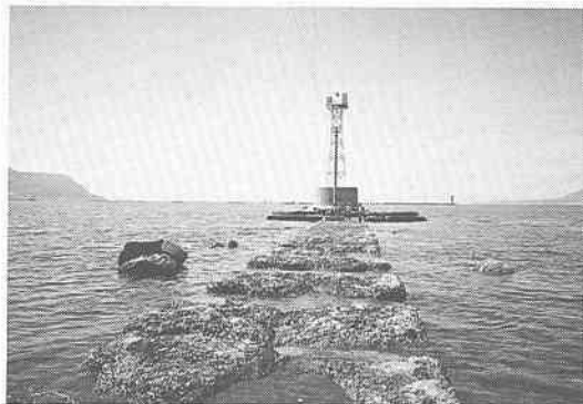
写真 10.3.11 函館港本港地区北副防波堤被災状況
