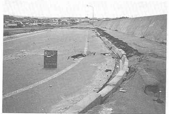
写真 10.4.2 森港西防波護岸背後の被災状況 （重力式構造区間）
