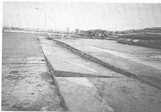
写真 10.3.7 函館港万代埠頭岸壁（-10.0 m）エプロン部被災状況
