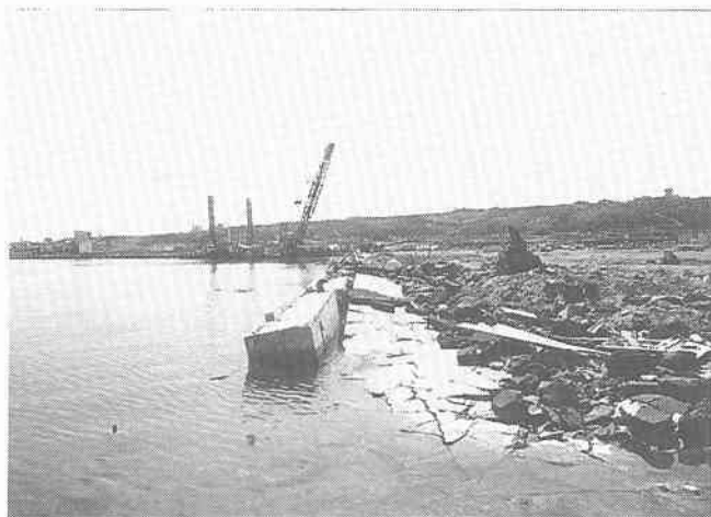
写真 10.6.4 青苗漁港-3.5 m 岸壁被災状況
