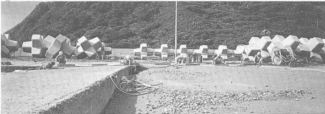
写真 10.7.1 須築漁港-4.0m 岸壁被災状況
