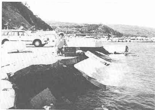
写真 10.2.5 奥尻港埠頭南物揚場の取付先端部の被災状況
