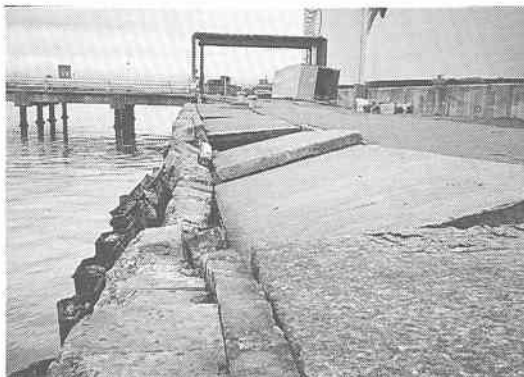
写真 10.3.10 函館港七重浜地区第3護岸被災状況
