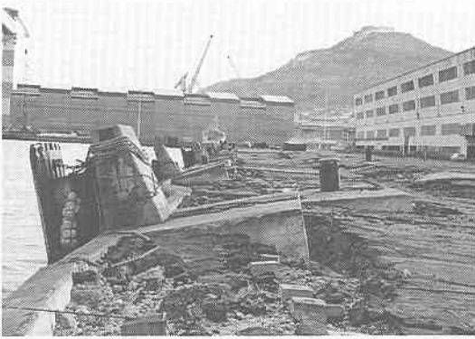
写真 10.3.1 函館港弁天地区第6岸壁 (-8.0 m) 被災状況 (法線部)
