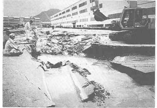
写真 10.3.2 函館港弁天地区第6岸壁 (-8.0 m) 被災状況 (エプロン部)
