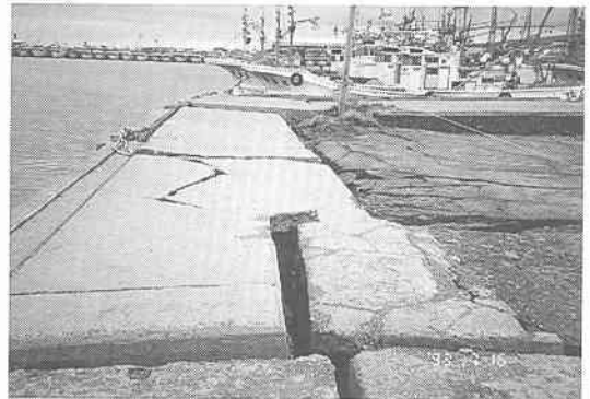
写真 10.4.7 森港中央埠頭岸壁取付先端部被災状況 (重力式構造区間)
