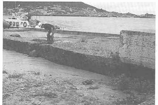
↑写真 10.3.6 函館港若松地区道路護岸 (-4.5 m) 被災 状況 (控え位置)
