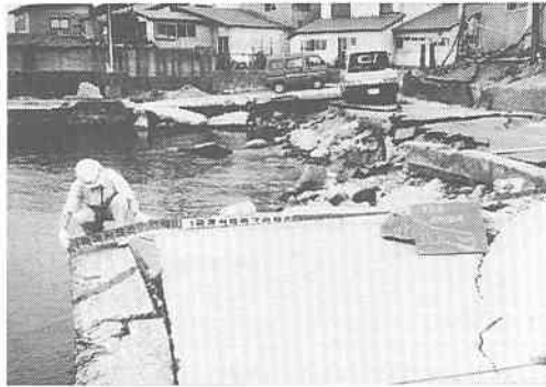
写真 10.2.4 奥尻港南物揚場の被災状況
