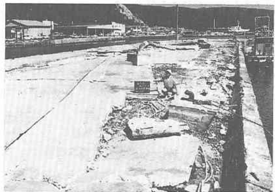
写真 10.2.3 奥尻港埠頭東外物揚場の被災状況
