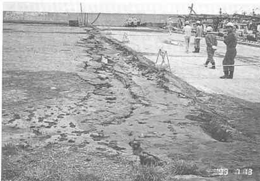
写真 10.4.3 森港西-2.5 m 物揚場被災状況
