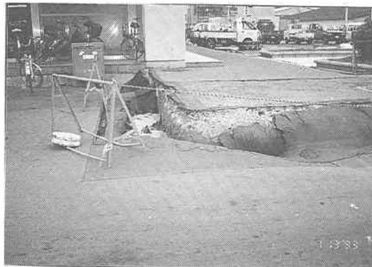
写真 10.3.3 函館港豊川地区豊川埠頭岸壁 (-5.0 m) エプロン部の被災状況
