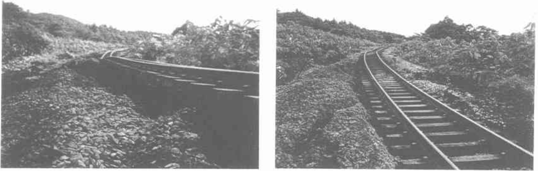
写真 8.3.7(左) 二股・蕨岱間の盛土変状 (124K080M 付近) (路盤が右側に大きく傾斜, 沈下し, レールが梯子状になる) 写真 8.3.8(右) 二股・蕨岱間の盛土変状 (124K130M 付近) (路盤が右側に大きく傾斜, 沈下し, 枕木が浮き上がっている)
