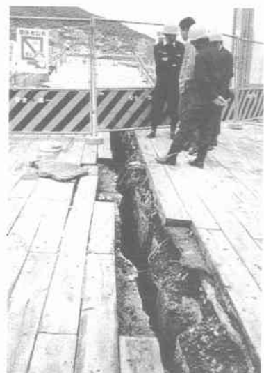
写真 8.3.4 シーポートプラザ(建物は長い支持杭基礎で沈下せず、建物の周囲の地盤に沈下が発生)
