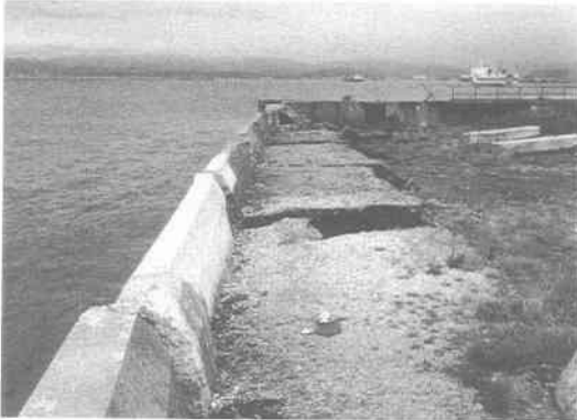
写真 8.3.1 旧有川棧橋(岸壁に不陸・食い違いが生じ背後の地盤が大きく沈下した)
