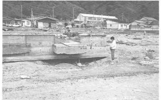
写真 4.9.8 土砂移動による構造物基礎の露出
