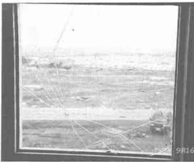
写真 4.9.7 風で飛来した小石によるガラスの破損
