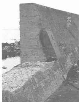
写真 4.9.4 打設不良の例
