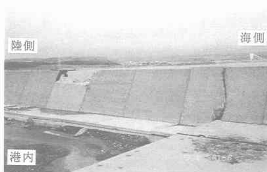
写真 4.9.5 青苗漁港東護岸の一部折損
