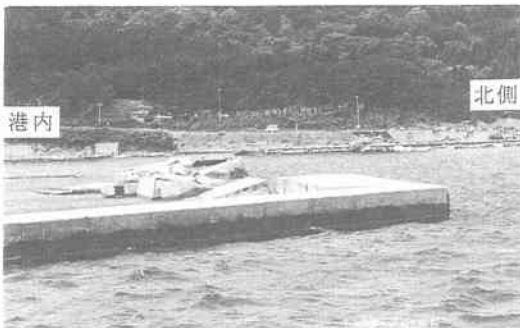
写真 4.9.1 奥尻港北防波堤の被災状況
