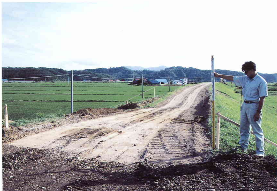
口絵写真-4 後志利別川の河川堤防の沈下
