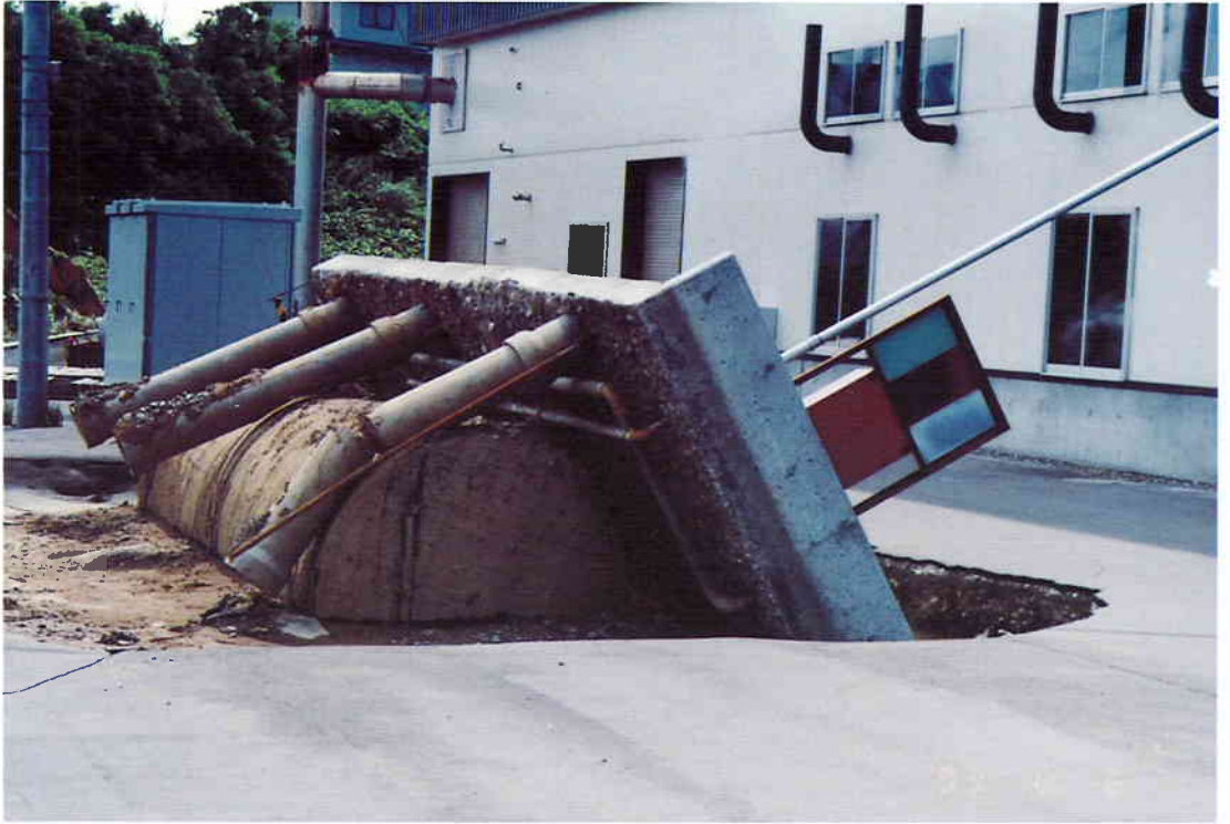
口絵写真-5 液状化による地下タンクの浮き上がり
