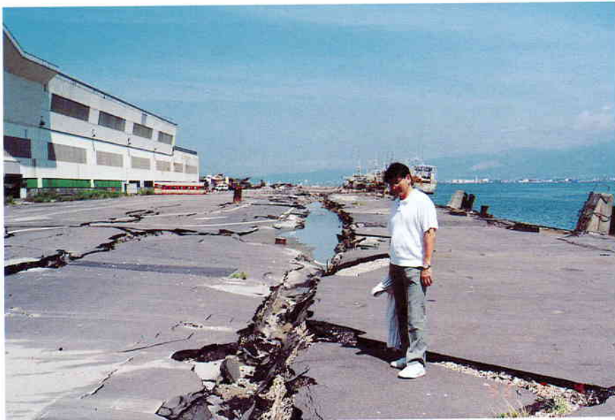
口絵写真-8 液状化による港湾施設の被害（函館港弁天地区）
