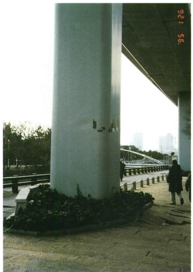
写真－２．６ コーナー部に曲率を有する 箱形断面の橋脚基部の 補剛板パネルの座屈
