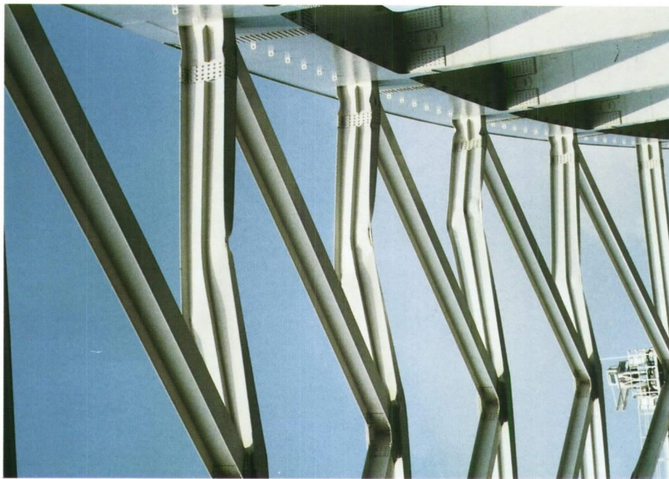
写真－２．２７ アーチ橋の上横繫材の座屈
