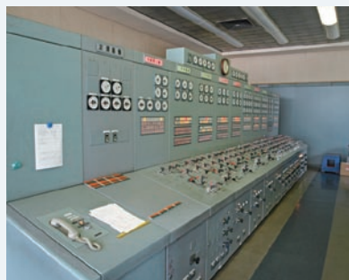
写真4 発電機制御盤
