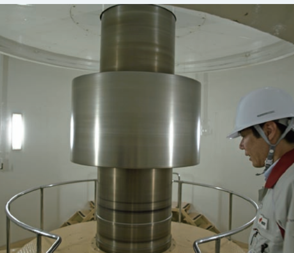
写真2 交流発電機の回転軸
