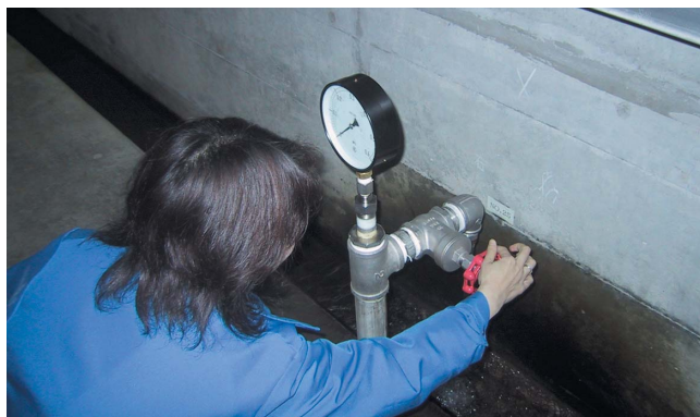
週に一度は堤体内に入って、クラックや漏水の監視、温度計やひずみ計の計測を行う
