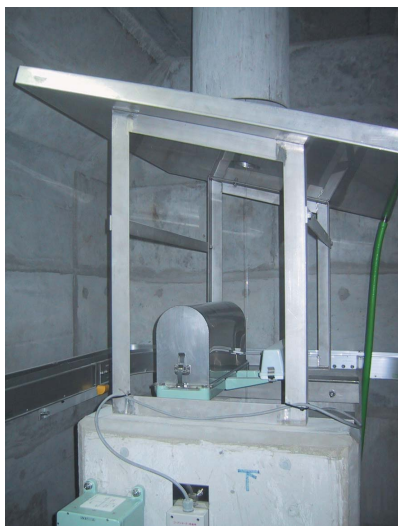
堤体に設置された堤体変位計
