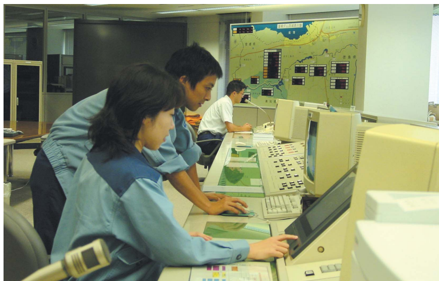
ダム管理操作室の様子
