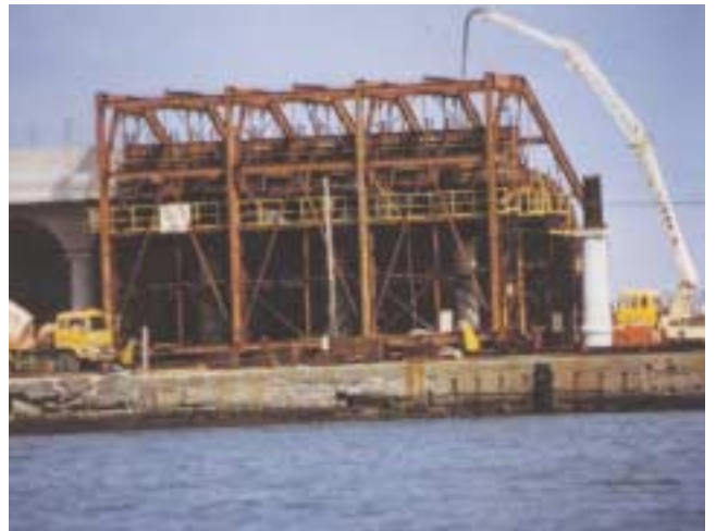
全面改修工事の様子。スライディングファームとして柱3本分60尺（18.18m）を1スパンとして施工（1980（昭和55）年頃撮影）
