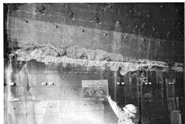
写真5-2 国道17号和南津トンネル接続部のはらみ出し状況
