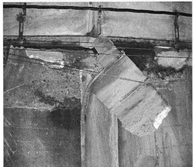
写真 5-4 JR 和南津トンネル接続部の崩壊
