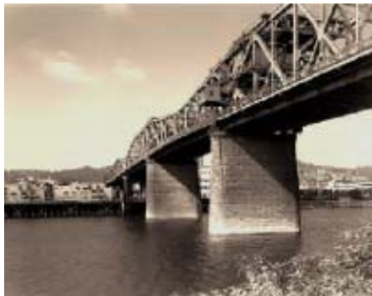
写真4.7 ブロードウェイ橋
