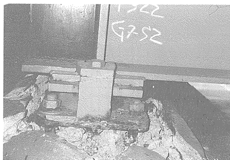
写 4.-1.2 阪神高速3号神戸線 沓座コンクリートの破壊 13)
