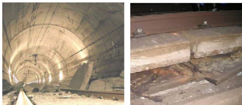
写-4.1.20 妙見トンネル被害状況 (202k500m 付近) 12)
