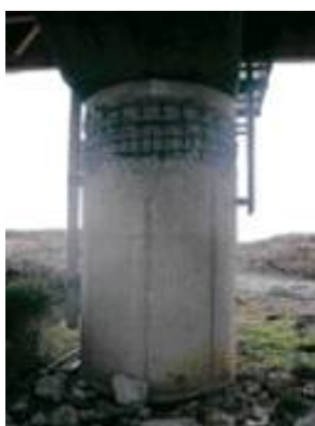
写-4.1.10 P5 橋脚損傷状況 9)
