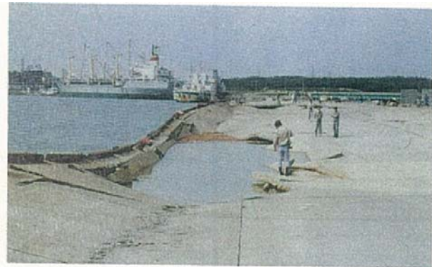
写－4.2.4 液状化による重力式護岸の押出
