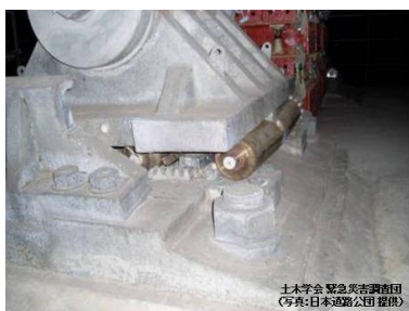
写-4.1.15 P2 橋脚支承部の損傷 11)
