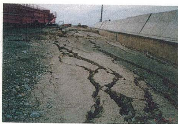
写—4.2.1 ポートアイランドでの地割れ (兵庫県南部地震にて)
