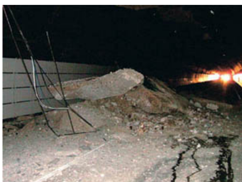
写-4.1.8 国道 17 号川口町和南津 トンネル損壊 9)
