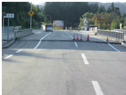
写-4.1.7 国道 8 号観音橋 路面段差 9)
