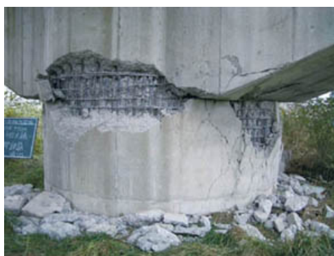
写-4.1.9 国道 17 号小千谷大橋 橋脚損傷 9)
