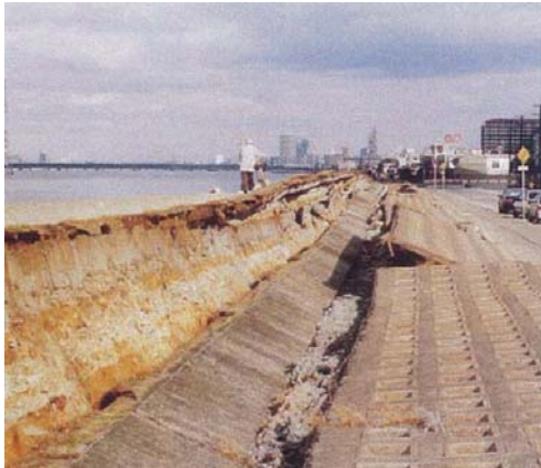
写－4.2.3 液状化による河川堤防の沈下
