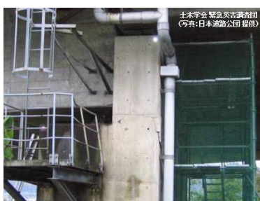
写-4.1.16 P3 橋脚段違い部の損傷 11)
