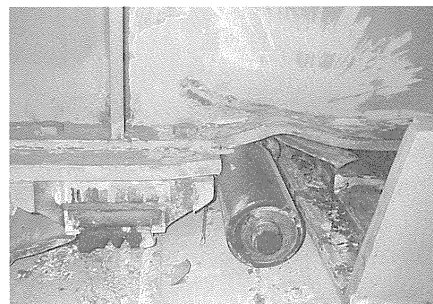
写-4.1.3 阪神高速3号神戸線 ローラー支承の損傷 13)
