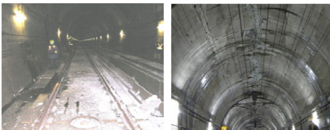
写-4.1.21 妙見トンネル被害状況 12)
