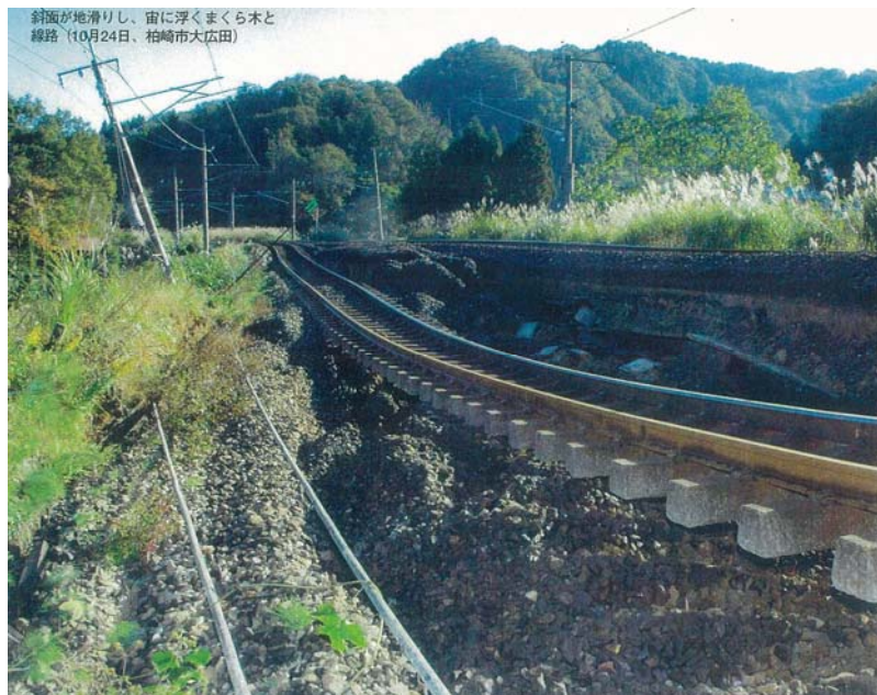
写－4. 2. 5 盛土被災状況（中越地震）
