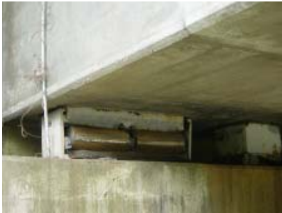
図-7 1P ラック・ピニオン損傷
