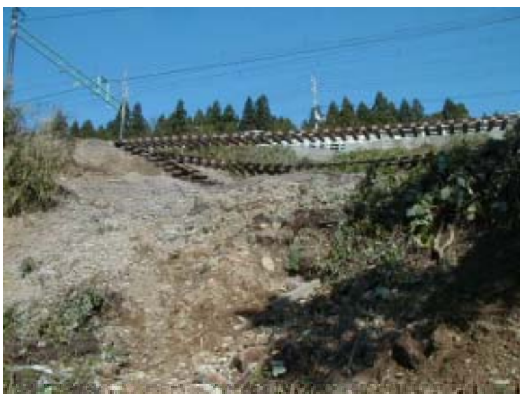
図一 3 上越線被災状況
