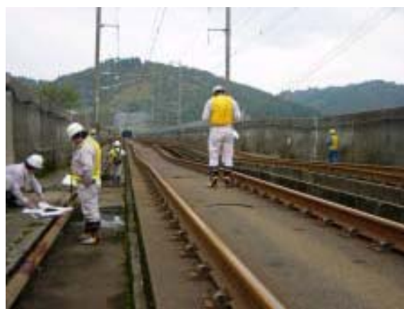
図-24 上部軌道面の沈下
