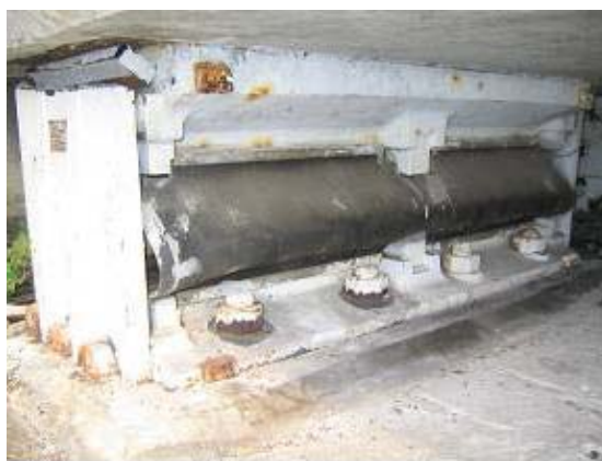
サイドブロック上部の破損
