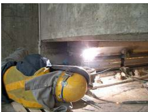
ラック取付状況
