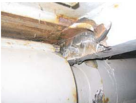
センターブロック損傷状況
