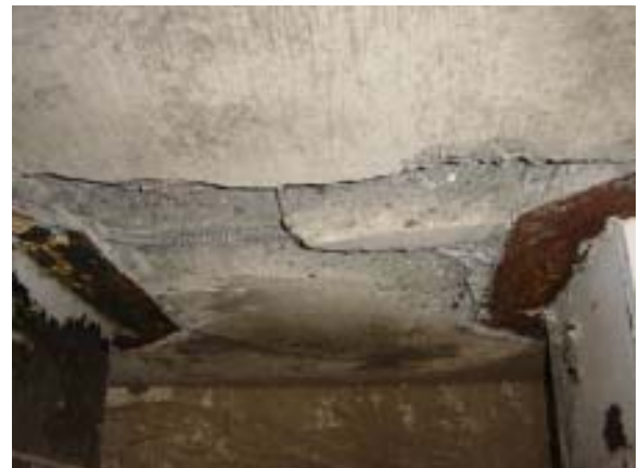
図-10 横桁損傷 (画面奥桁端)
