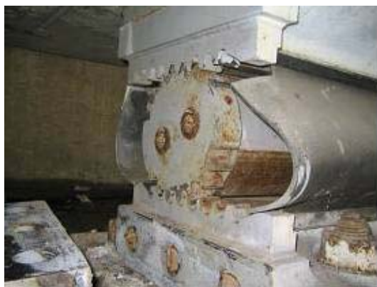
サイドブロックボルトのせん断破壊
