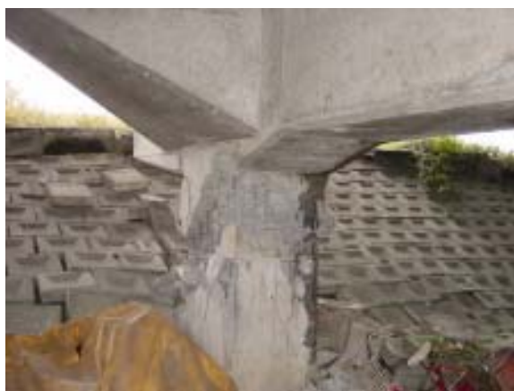
図-19 損傷状況 (R2-4)
