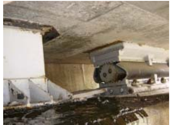
図-8 1P サイドブロック損傷
