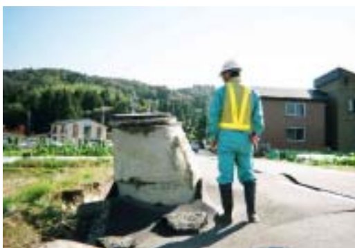
写真3.6.2 液状化により隆起したマンホール
