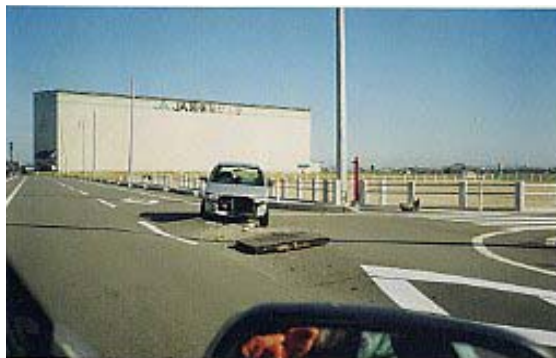
写真3.6.3 マンホール隆起による事故現場
