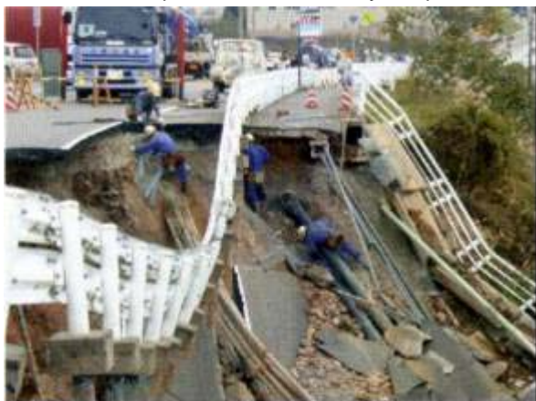
写真3.6.4 国道17号盛土の被害状況
