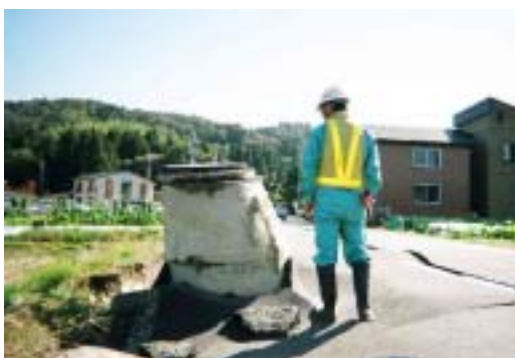
写真3.6.2 液状化により隆起したマンホール
