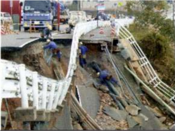
写真3.6.4 国道17号盛土の被害状況 Phot.3.6.4 Damage along the National Road No.17
