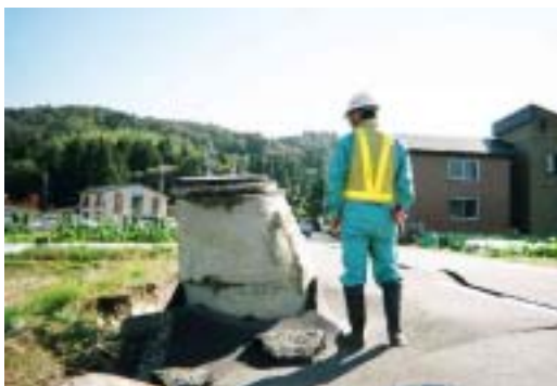
写真3.6.2 液状化により隆起したマンホール Phot.3.6.2 Uplifted manhole by liquefaction
