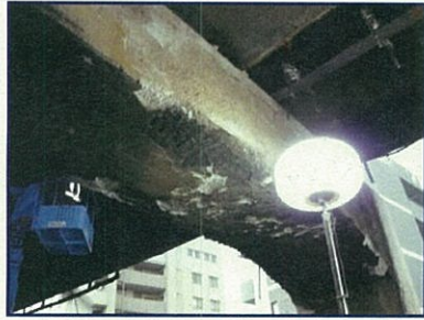
①橋脚(池-601)横梁損傷状況
