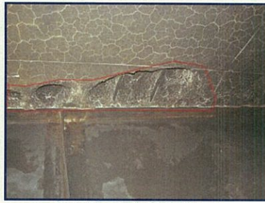
③上層 床版損傷状況
