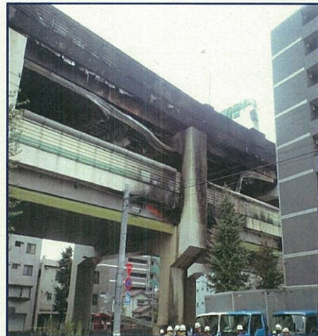
①上層橋桁・床版等の損傷状況
