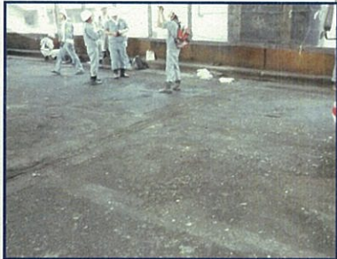
④下層路面の上層裏面吸音板アルミ材付着状況
