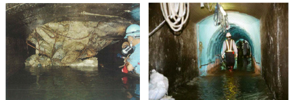
崩落箇所全景
